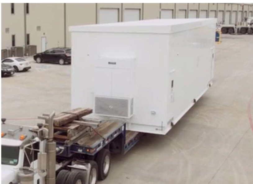
KUVA 4. Eatonin e-house kuljetuksessa (Eaton).
