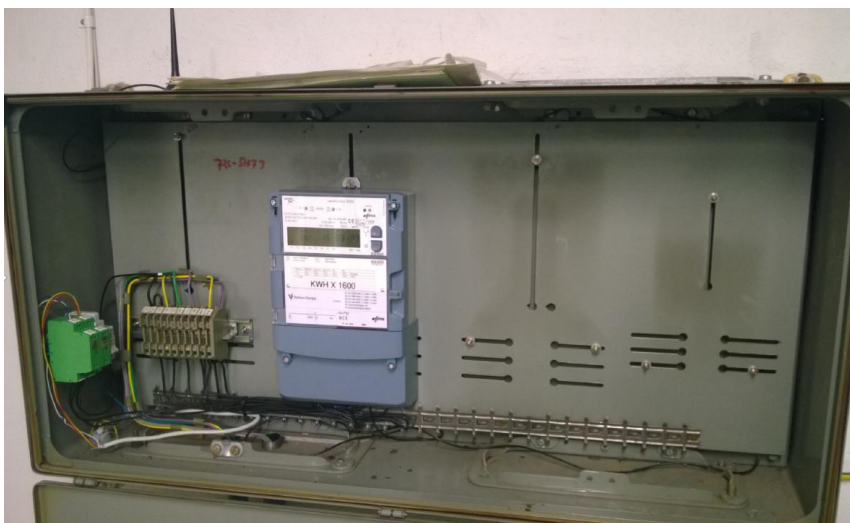
Kuva 14. Epäsuora 20 kV:n mittaus mittarinvaihdon jälkeen.
