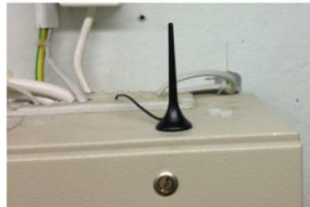
Kuva 7. 2ek-kotelon ulkopuolelle tuotu antenni.
