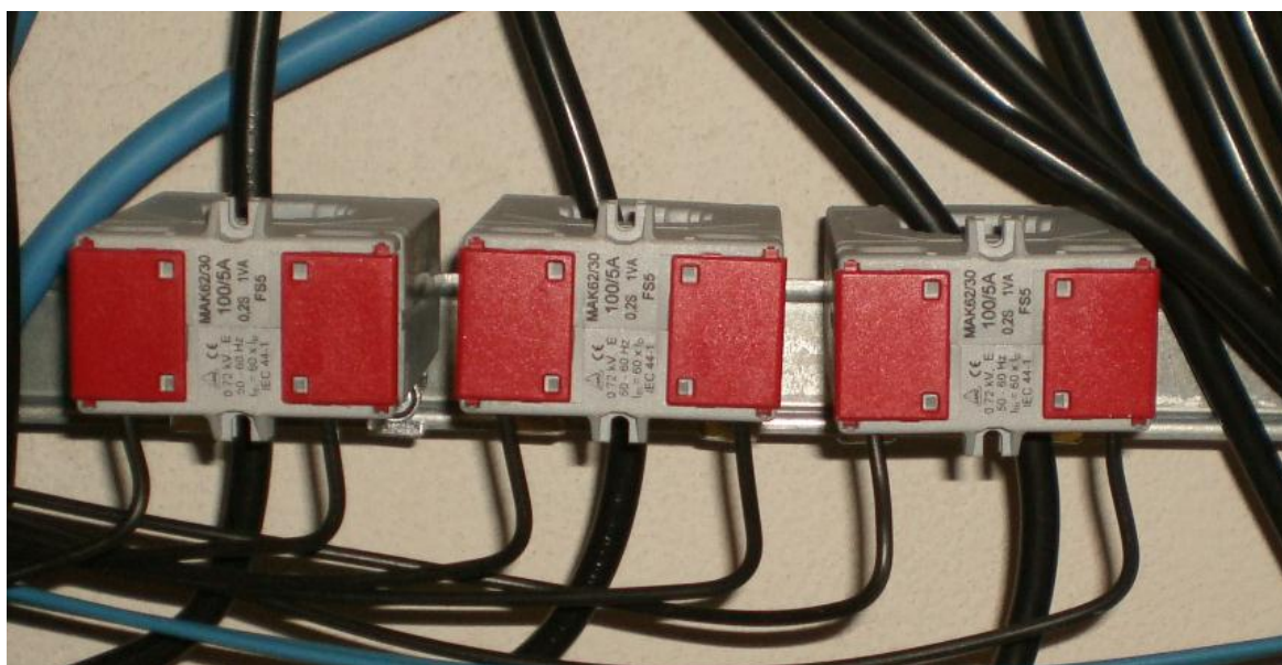
Kuva 9. Virtamuuntajat epäsuorassa 0,4 kV:n mittauksessa.
