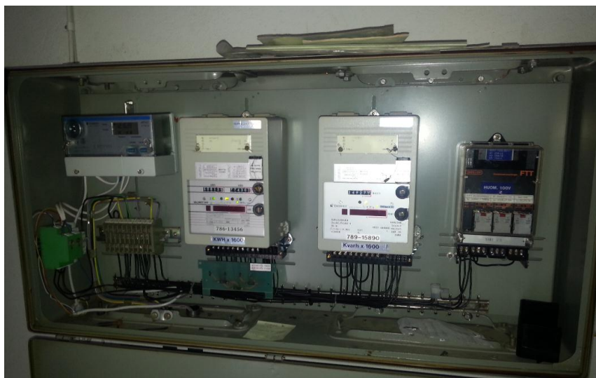
Kuva 13. Epäsuora 20 kV:n mittaus ennen mittarinvaihtoa.
