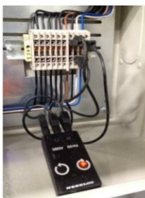
Kuva 6. Vaiheiden kiertosuunnan mittaaminen.
