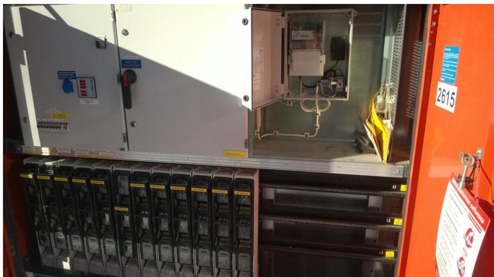
Kuva 16. Muuntamolle asennettu EMPC100i-keskitin.
