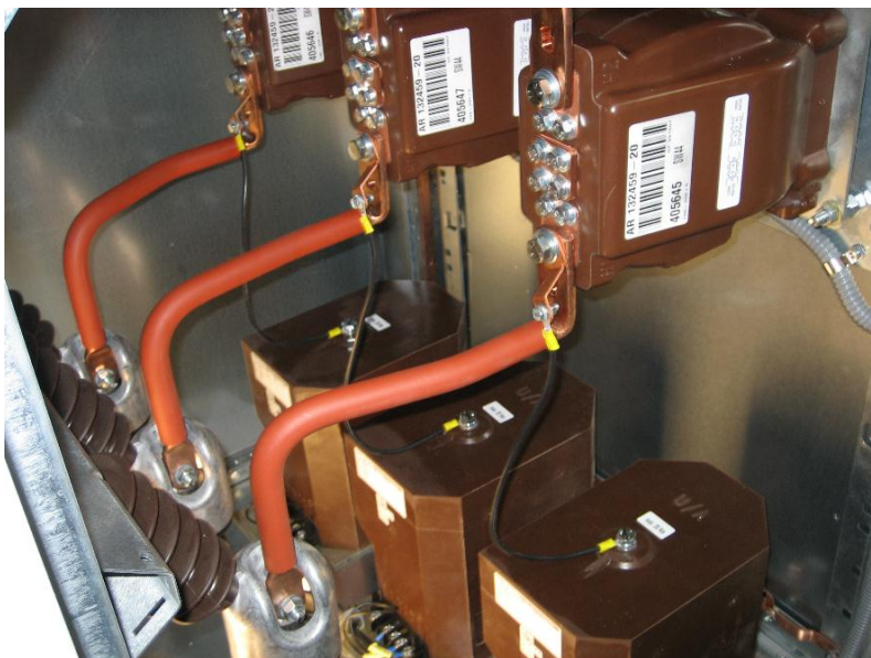
Kuva 8. 20 kV:n mittauksen mittamuuntajat.
