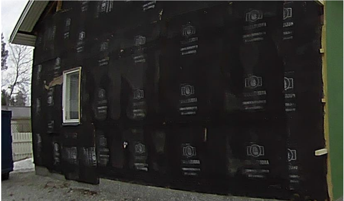
Kuva 7.2. Kuvassa näkyy pohjoisen puoleinen seinä. Seinässä on tuulensuojalevyt joissa näkyy harmaina laikkuina mikrobikasvustoa.
