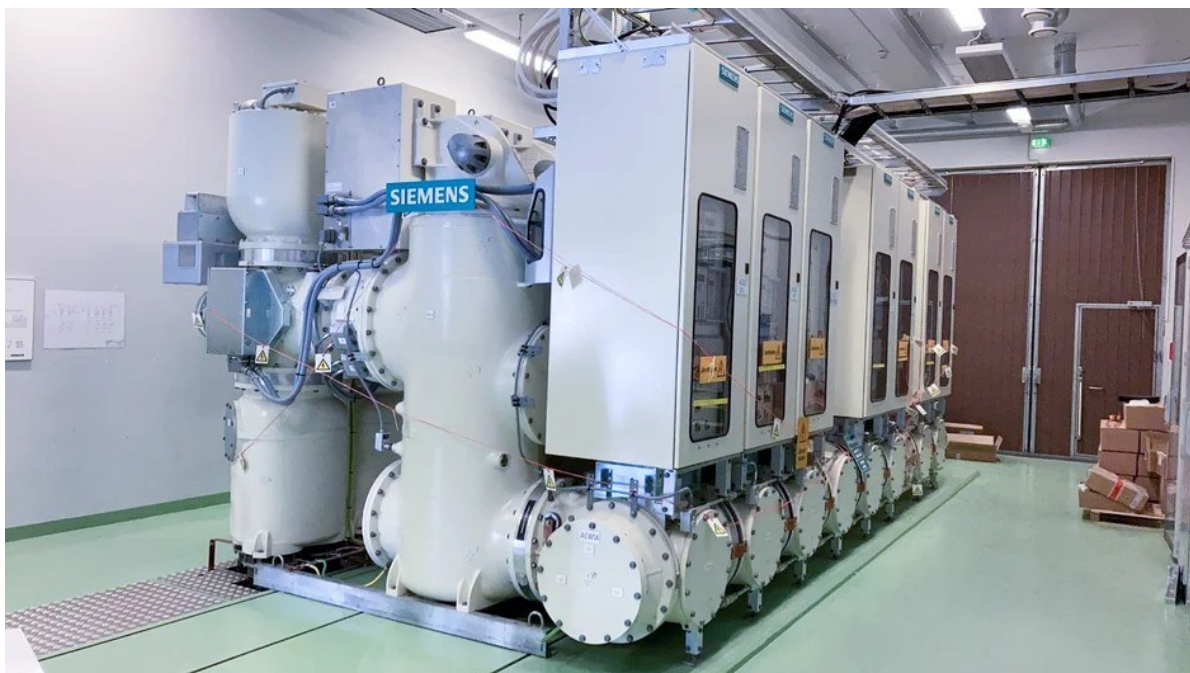
KUVA 11. 110 kV GIS-kojeisto Ilohajun sähköasemalla Kuopiossa (Ases 2024)
