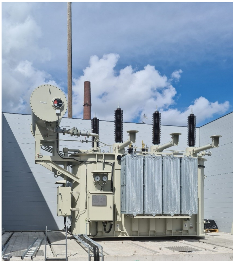
KUVA 12. 110/20 kV tehomuuntaja muuntajabunkkerissa. (Multirel 2020)
