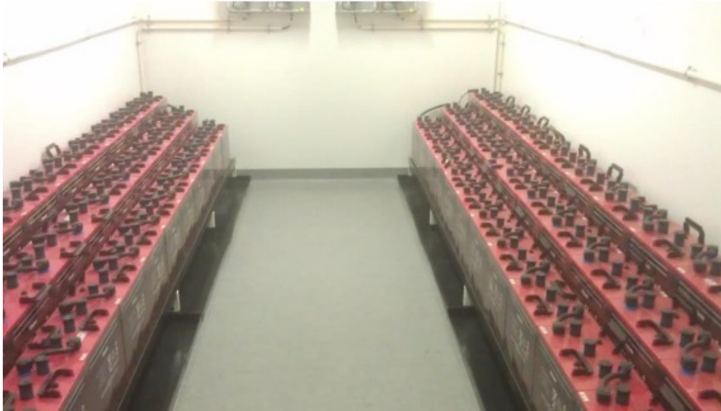
KUVA 16. Apusähköjärjestelmän akusto (Tähtinen, 2015)
