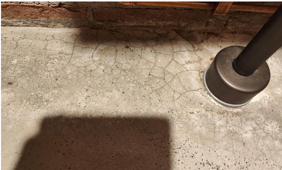
Kuva 7. Esimerkki kuva halkeilevasta betonilattiasta. [33].
