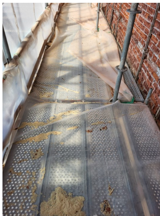
Kuva 18. Muovitettu julkisivuteline, muovin päälle kerääntynyt pölyä, jonka muovi on estänyt varisemasta alemmille kerroksille (Juho 2025)
