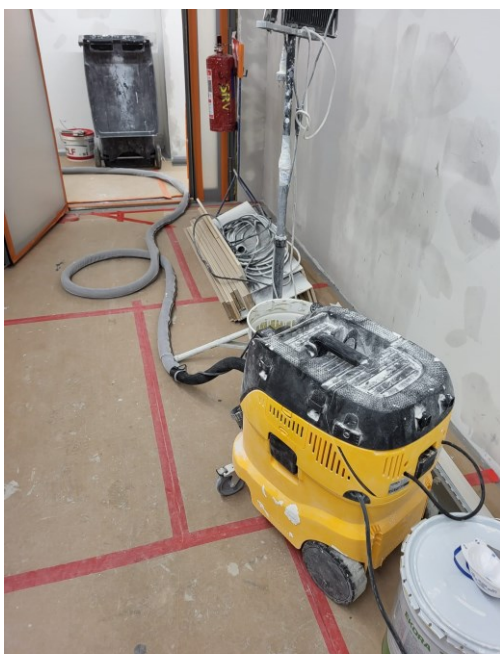
Kuva 7. Hiomakoneen kohdepoistoimuri viereisessä tilassa (Juho 2023)
