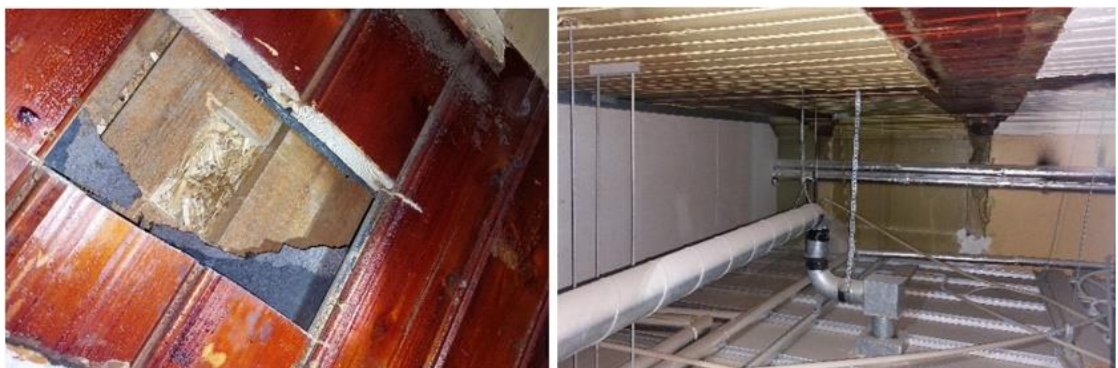
Kuva 18. Katon puupaneelin takana on tervapahvia pohjoissiivessä (YP4).
