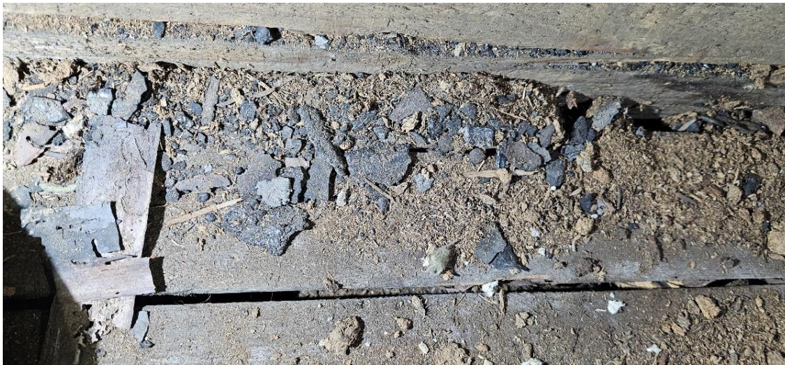
Kuva 19. PAH-yhdiste- ja asbestipitoista pikimurua ullakolla.
