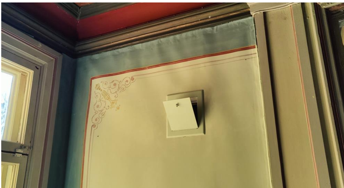
Kuva 15. Sisäilmahaittaa hallittiin parantamalla korvausilmansaantia asentamalla tiloihin kippiluukkuja. (Kuva AFRY Finland Oy, Juho Laaksonen).
