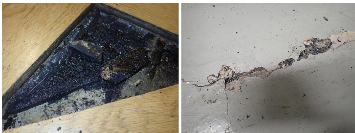
Kuva 2. Vasemmanpuoleisessa kuvassa on parketin alla paksu bitumiliimakerros ja oikeanpuoleisessa kuvassa ohut kerros pikisivelyä alapohjan maali- ja tasoiterrosten alla. Materiaalit ovat samasta 1920-luvulla valmistuneesta rakennuksesta. (Kuvat AFRY Finland Oy, Paula Wuokko).
