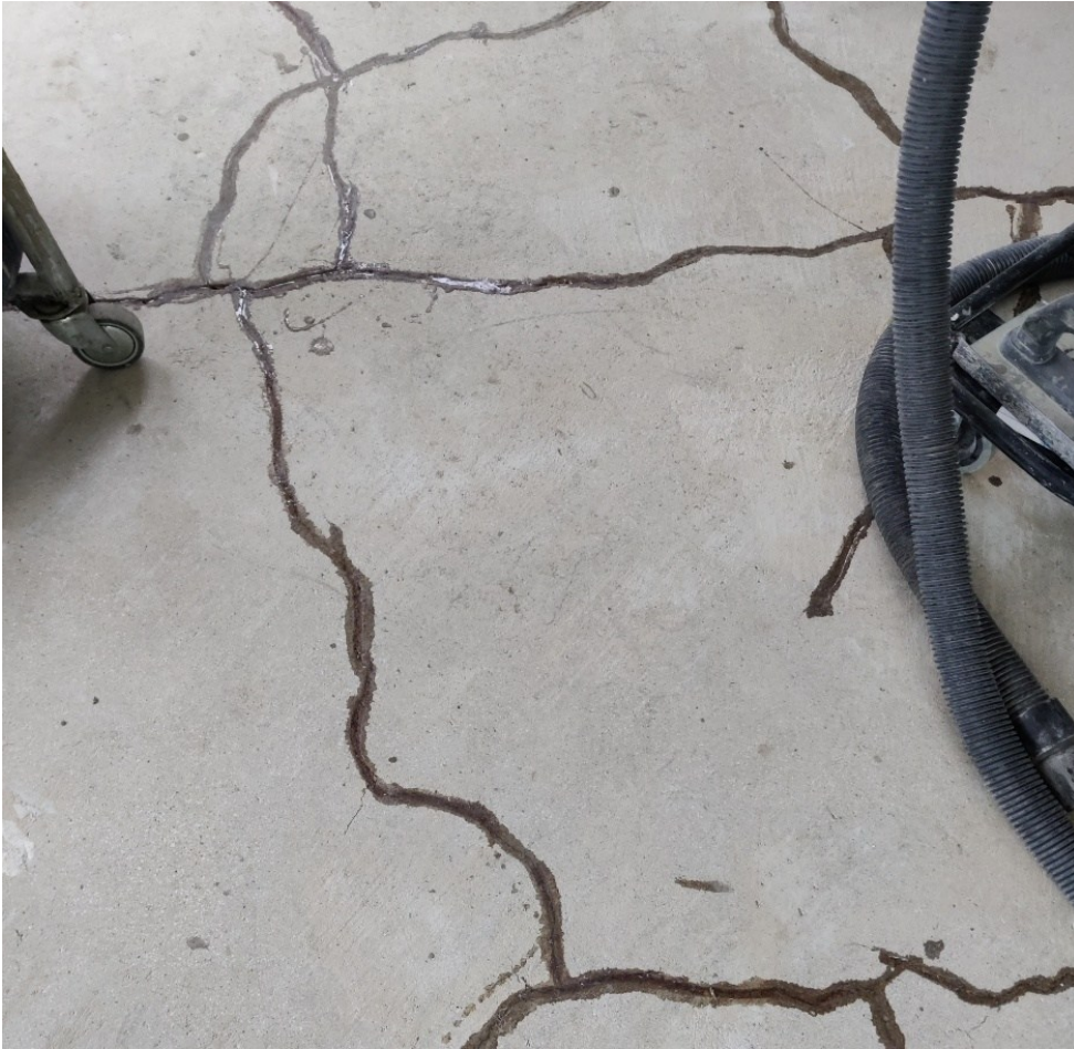
KUVA 2. Betonilattian halkeamia, jotka korjattu injektoimalla.
