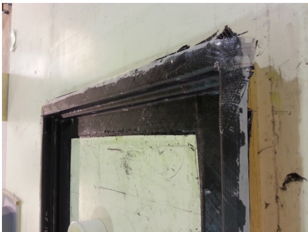
Kuva 16 Laminaatti Peelplyn asettamisen jälkeen. Tämä kerros varmistaa muiden laminaatin päälle tulevien materiaalien irtoamisen.
