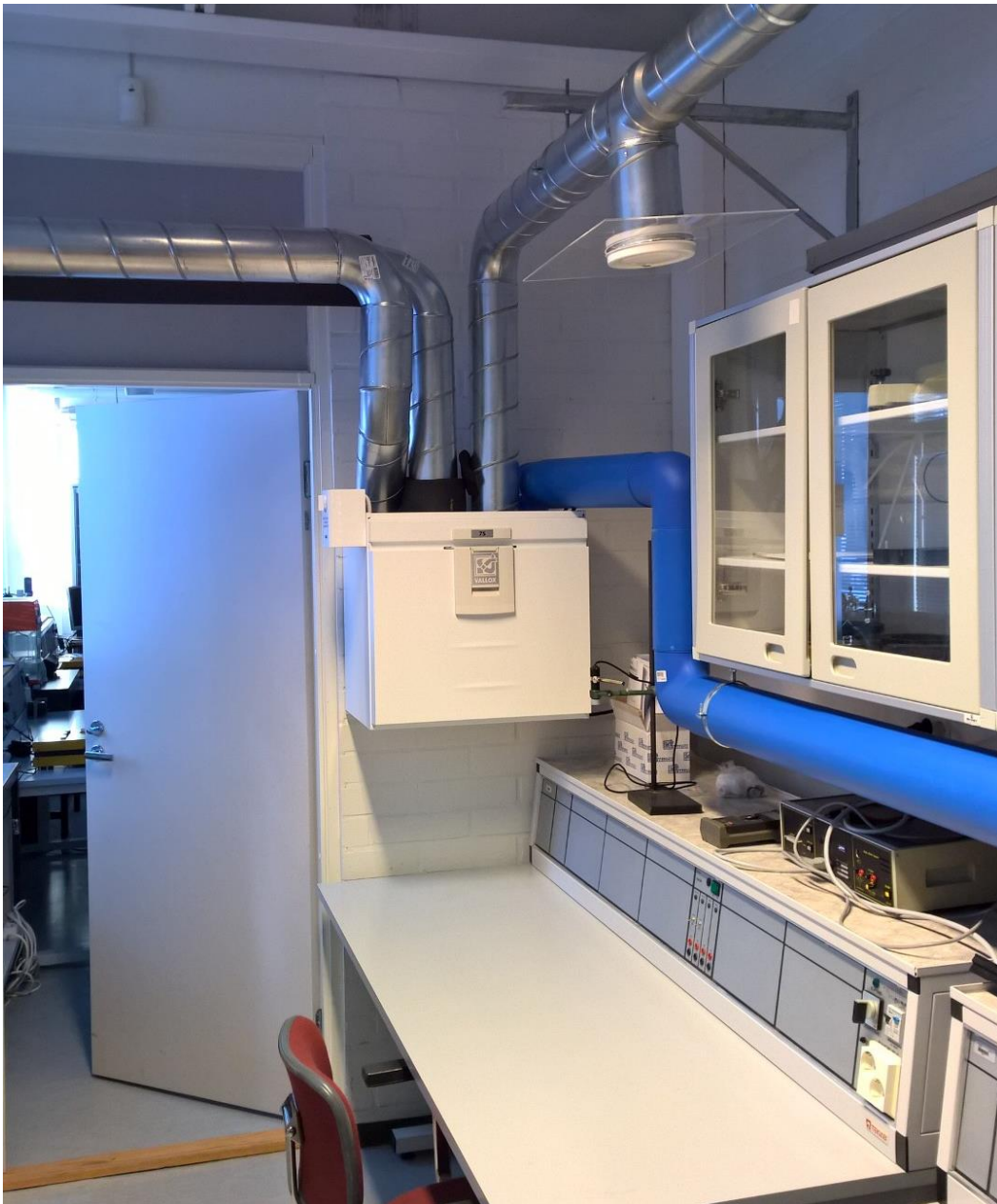
KUVA 5. Fysiikan laboratorioon asennettu IV-kone ja siitä lähtevä kanavisto
