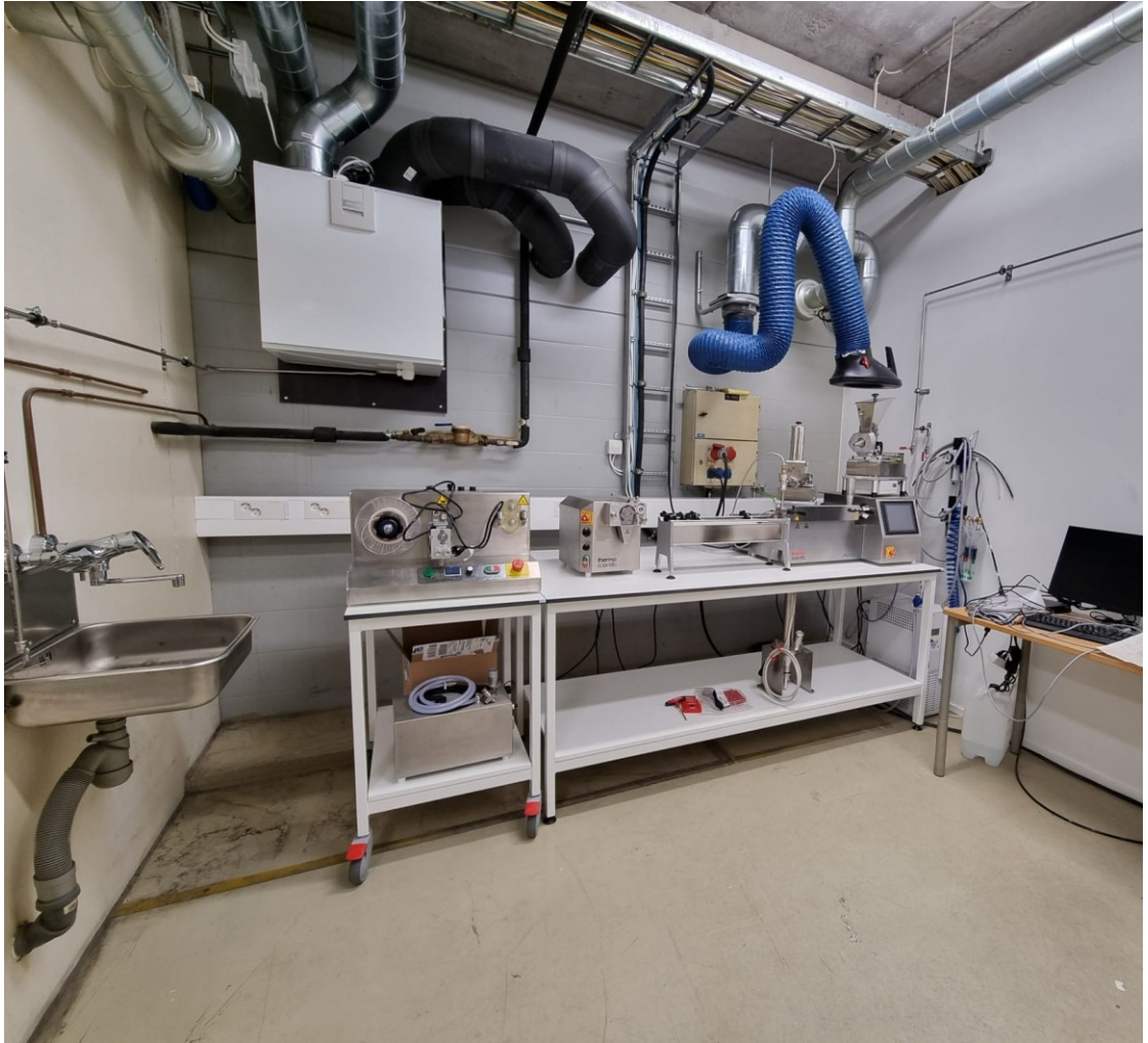
Kuva 13. Muovilaboratorion uusi laite käyttövalmiina.
