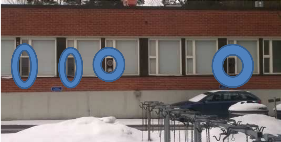
KUVA 4 Ilmanvaihtolaitteistojen päätelaitteet ulkona
