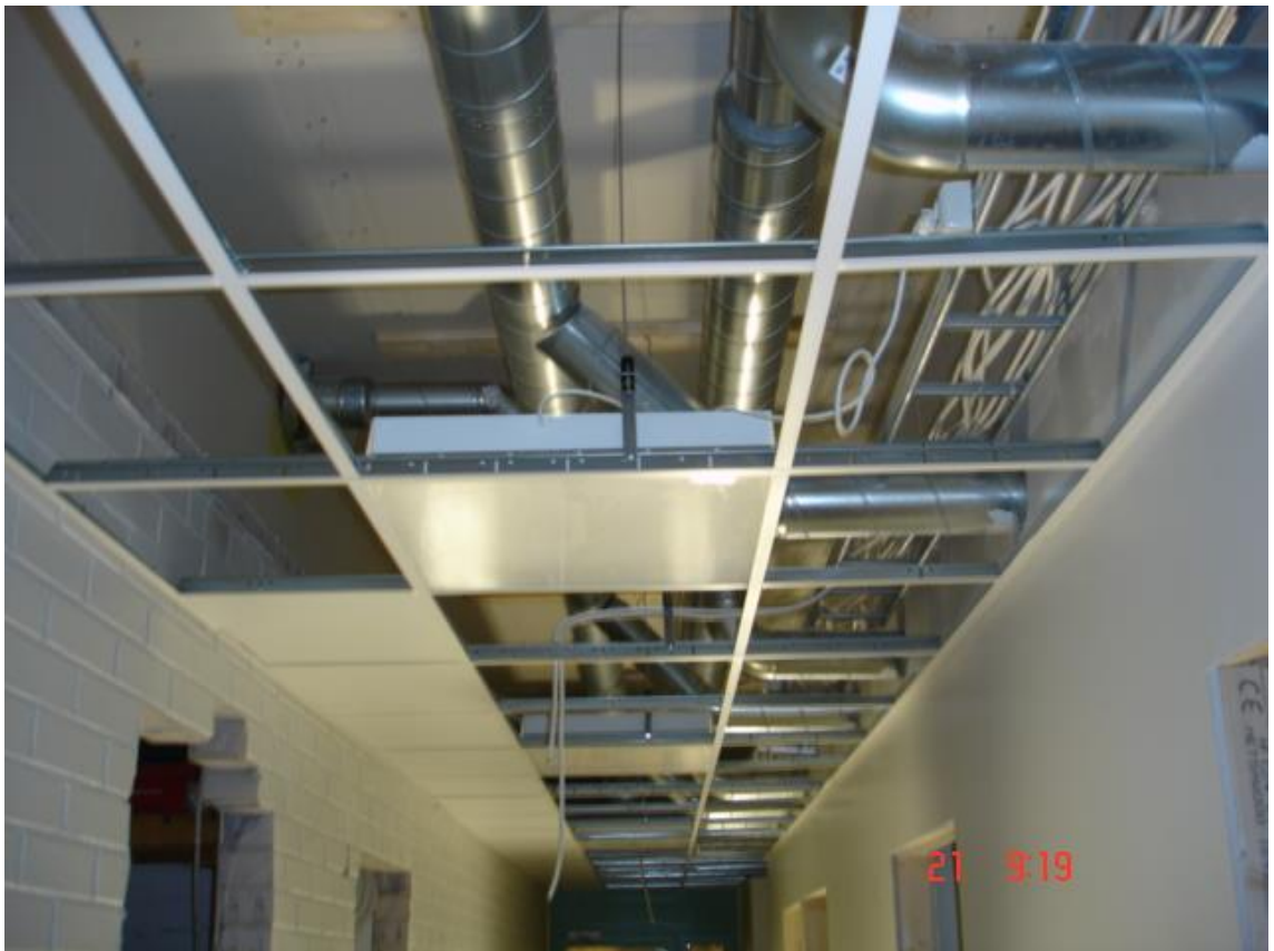
KUVA 12. Uutta talotekniikkaa, (Kuva: Ilpo Kataja 2013)
