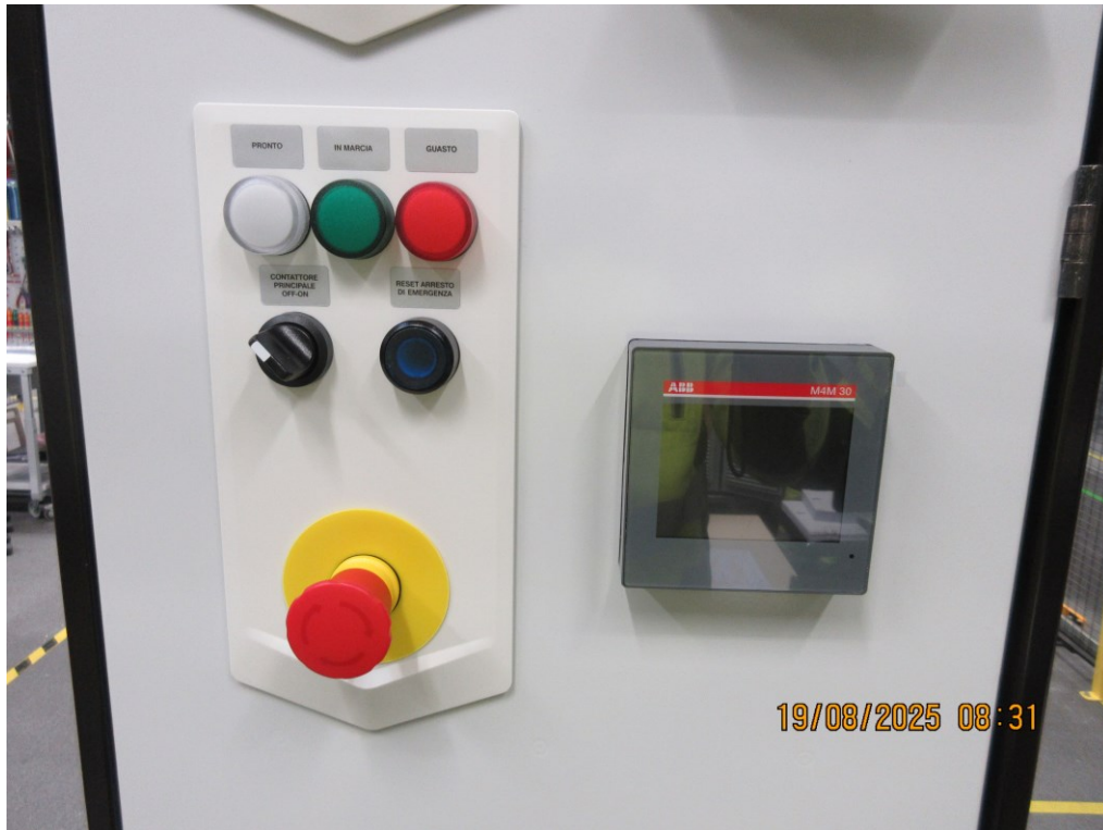
Kuva 5. Verkkoanalysointilaite M4M asennettuna oikealla taajuusmuuttajakaapin oveen.
