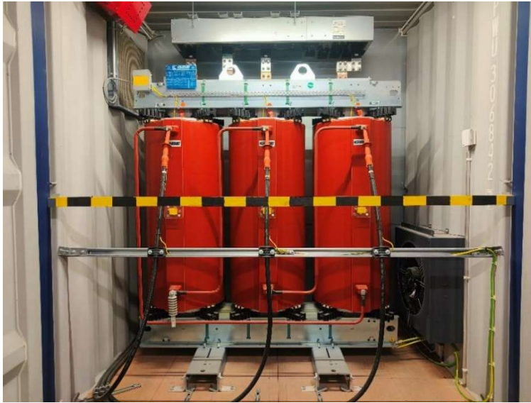
Kuvio 8. Kuivamuuntaja hartsieristeen 1600 kVA 20/0,69 kV, joka on tyypiltä sydänmuuntaja ja samanlainen kuin tässä opinnäytetyössä käytetty
