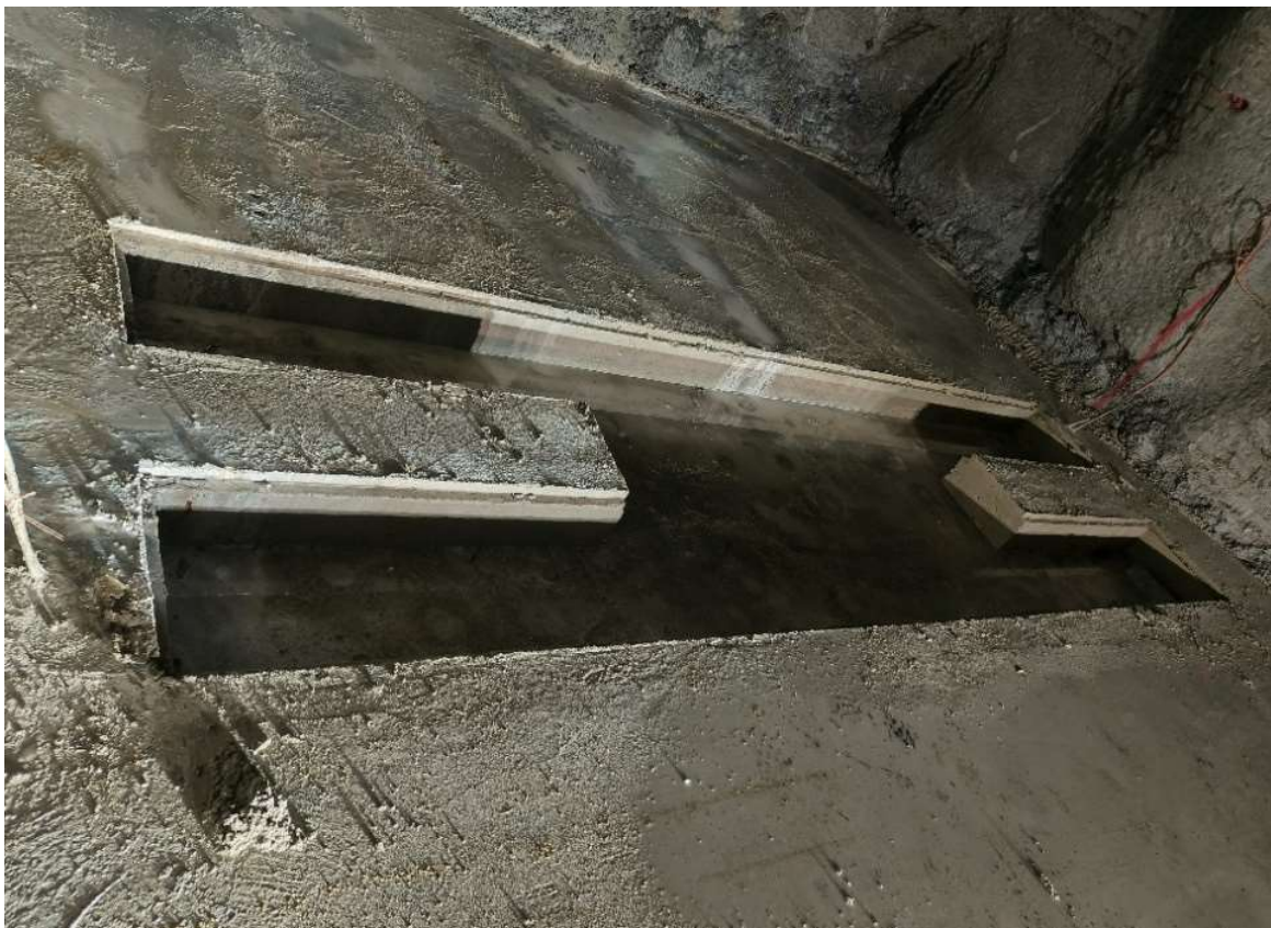
Kuvio 34. Muuntamon lattiavalu, jossa kaapelikanava
