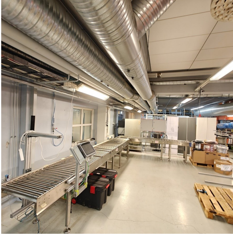
Kuva 2. Rullakuljetin asennettu nykyiseen sijaintiin.
