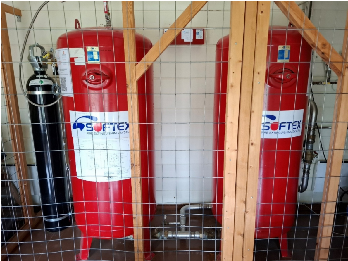
Kuva 3.23 Puukirkon Softexin sammutusvesisäiliöt lukitussa tilassa kirkon 2. kerroksessa.
