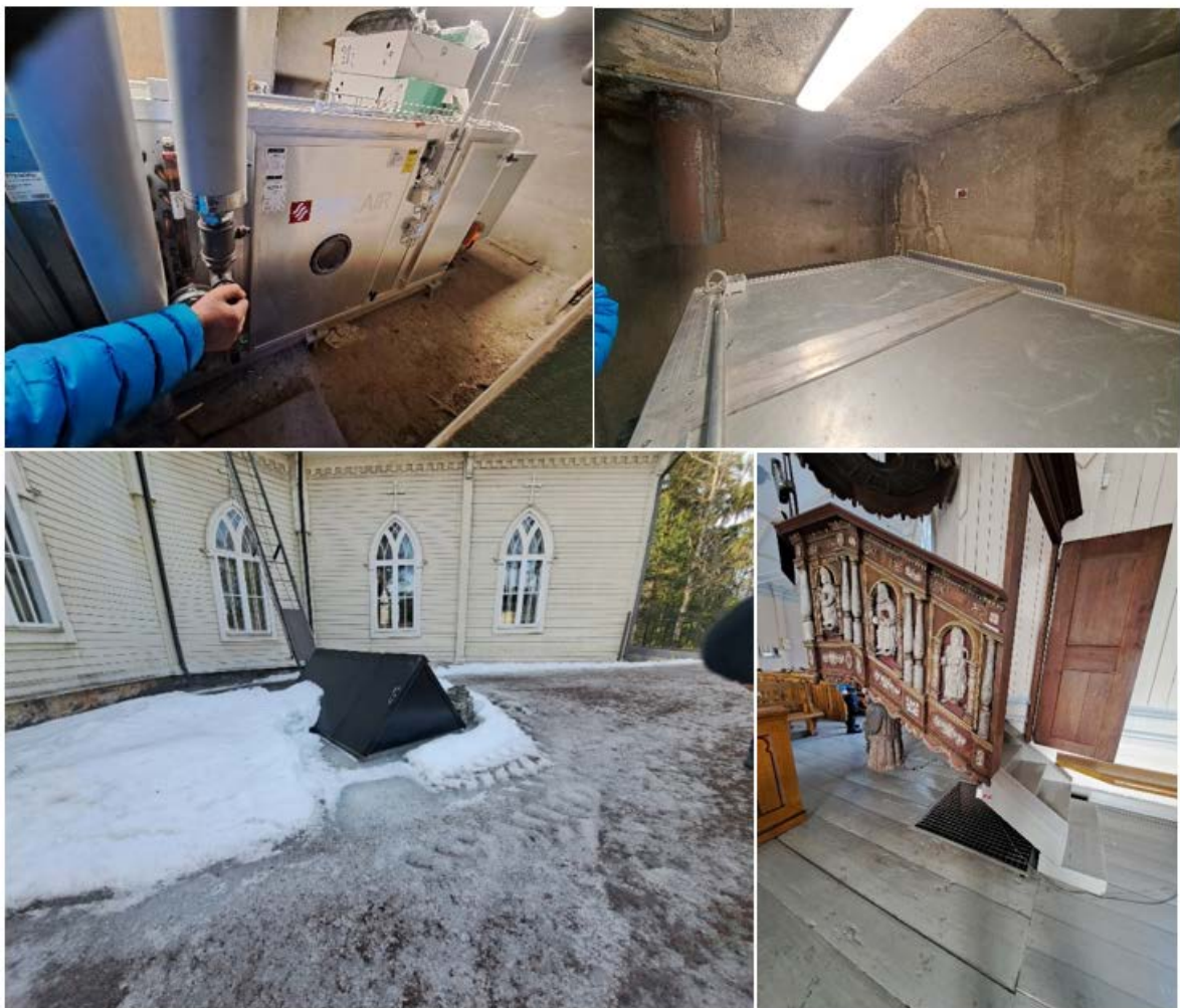
Kuva 3.12 Vasemmalla alhaalla IV-konehuoneen sisäänkäyntiovi ja alhaalla oikealla kirkkosalin tulopuhalluselimen sijoituspaikka, josta lämmin ilma puhalletaan sisälle. Ylhäällä molemmat kuvat IV-konehuoneesta.
