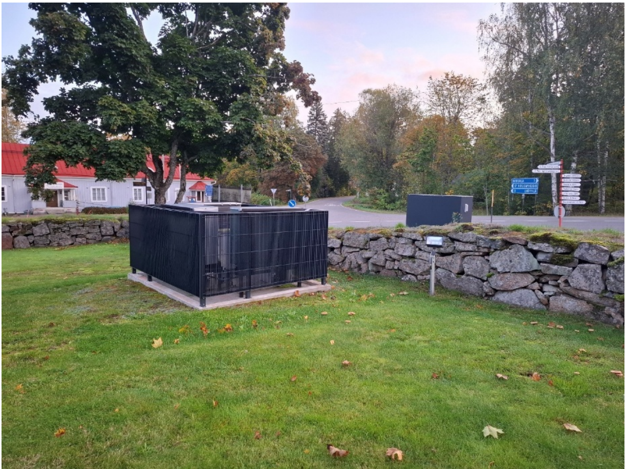
Kuva 3.16 Vuonna 1869 valmistunut puukirkko, jossa ilmavesilämpöpumppujärjestelmän ulkoyksiköt on sijoitettu 20 metrin päähän ulkoseinästä kiviaidan viereen. Öljykattila on jätetty varalämmitysjärjestelmäksi.
