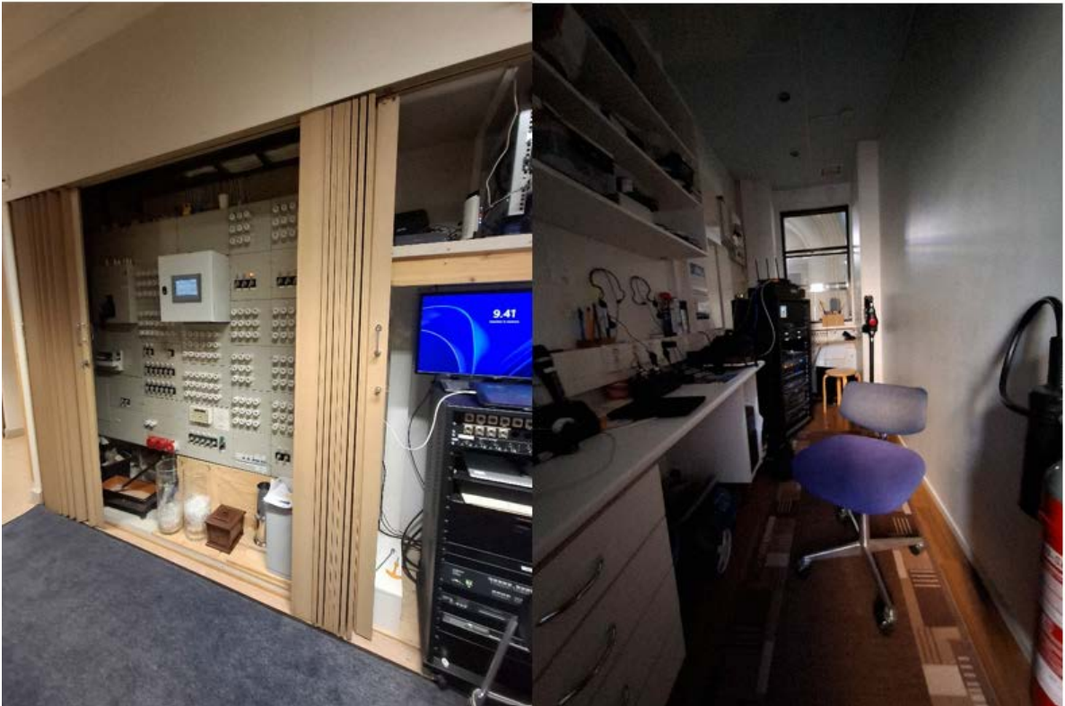
Kuva 3.22 Vasemmassa kuvassa erään kirkon audiovisuaalisen tekniikan hallintajärjestelmä oikealla, lisäksi näyttö kameravalvontajärjestelmää varten. Vasemmalla sähköpääkeskus. Oikeassa kuvassa laitteistoja varten on oma tekninen tila kirkon eteistilan ja kirkkosalin välissä.
