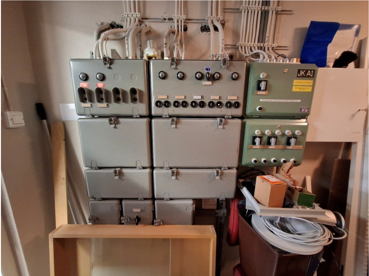
Kuva 3.15 Esimerkkikuva seurakuntakeskuksesta. Tyypillinen 1960–70-luvun sähköjärjestelmän jakokeskus kellaritilassa, jonka käyttöikä on jo ohitettu.
