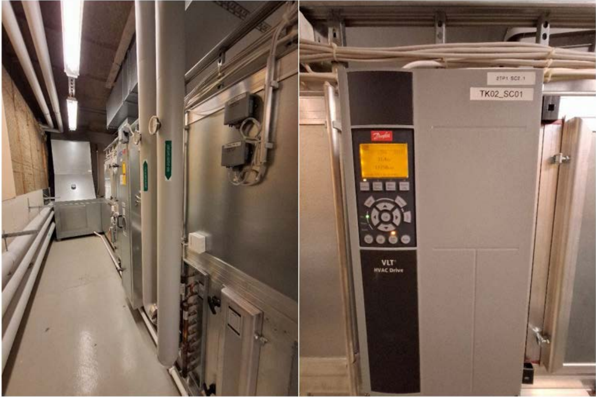
Kuva 3.13 Kuvia seurakuntakeskuksen IV-konehuoneesta ja IV-kone, jossa keskellä lämmityspatteri. Oikealla IV-kone, TK2:n taajuusmuuttaja.
