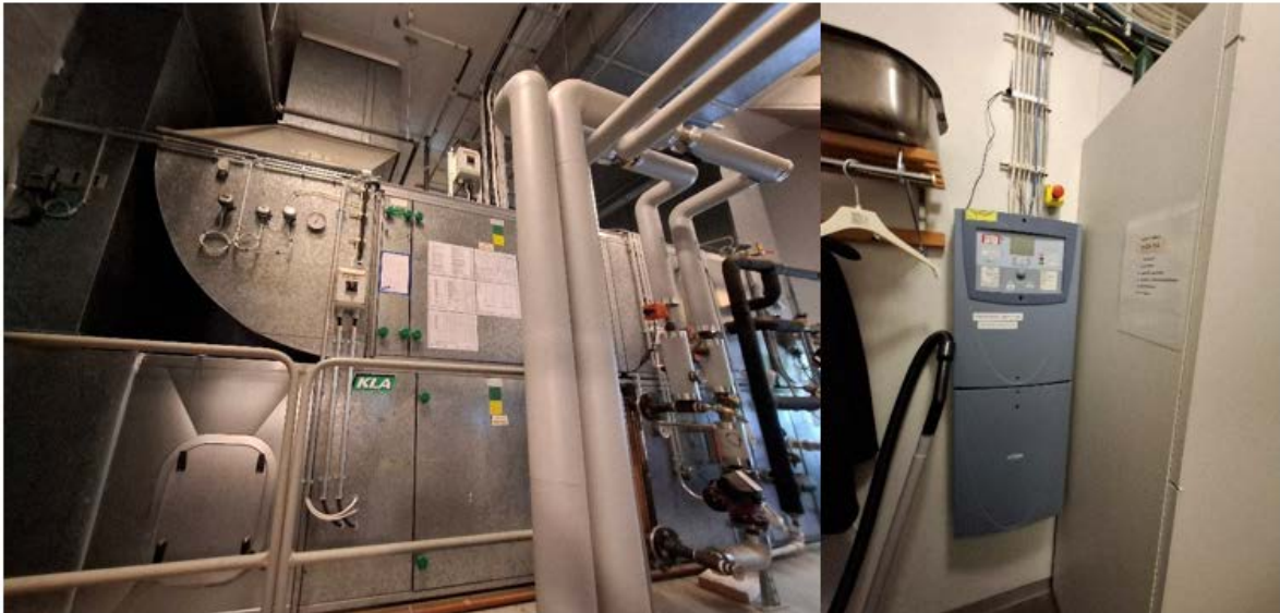
Kuva 3.11 1850-luvulla valmistunut kookas kivikirkko, jonka kellaritilassa on suuri IV-järjestelmän kojeisto. Kuvassa kirkkosalin IV-kone ja ohjeislaitteistoa. Laitteisto on asennettu v. 2010 peruskorjauksessa. Oikealla tyypillinen kirkon paloilmotinkeskus, joka sijaitsee yleensä pääsisäänkäynnin edessä eteistilassa.
