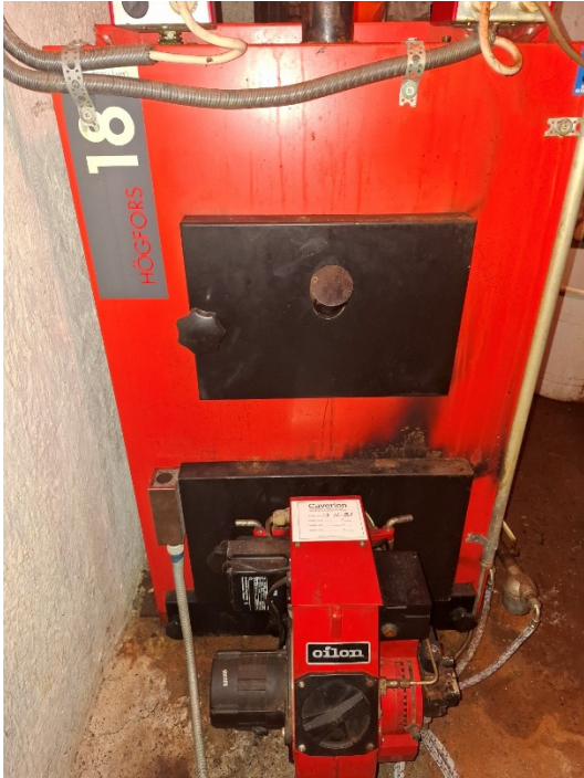
Kuva 3.25 Vanha Oilonin polttimolla varustettu Högforsin kaksoispesäkattila, joka on talvella satunnaisesti käytössä erään puukirkon lämmityksessä. Kuvasta voi havaita tarkastuslaitoksen huoltoajankohdan, joka on ollut vuonna 2021. Lämpövuodot olisi syytä tarkastaa.
