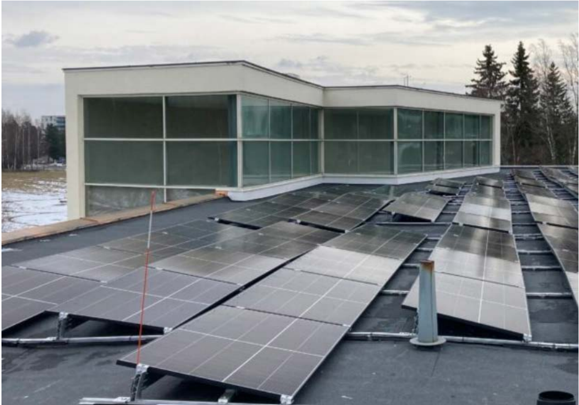
Kuva 3.18 Vuonna 1994 valmistuneen kirkkorakennuksen katolle asennetut aurinkopaneelit.
