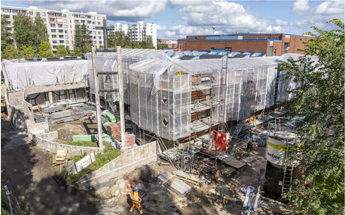
Kuva 3.26 Yllä olevassa kuvassa on käynnissä vuonna 1979 valmistuneen kirkkorakennuksen perusteellinen peruskorjaus, jossa mikrobivaurioitunut julkisivu sekä LVIS-tekniikka uusitaan ja lämmöneristystä parannetaan.
