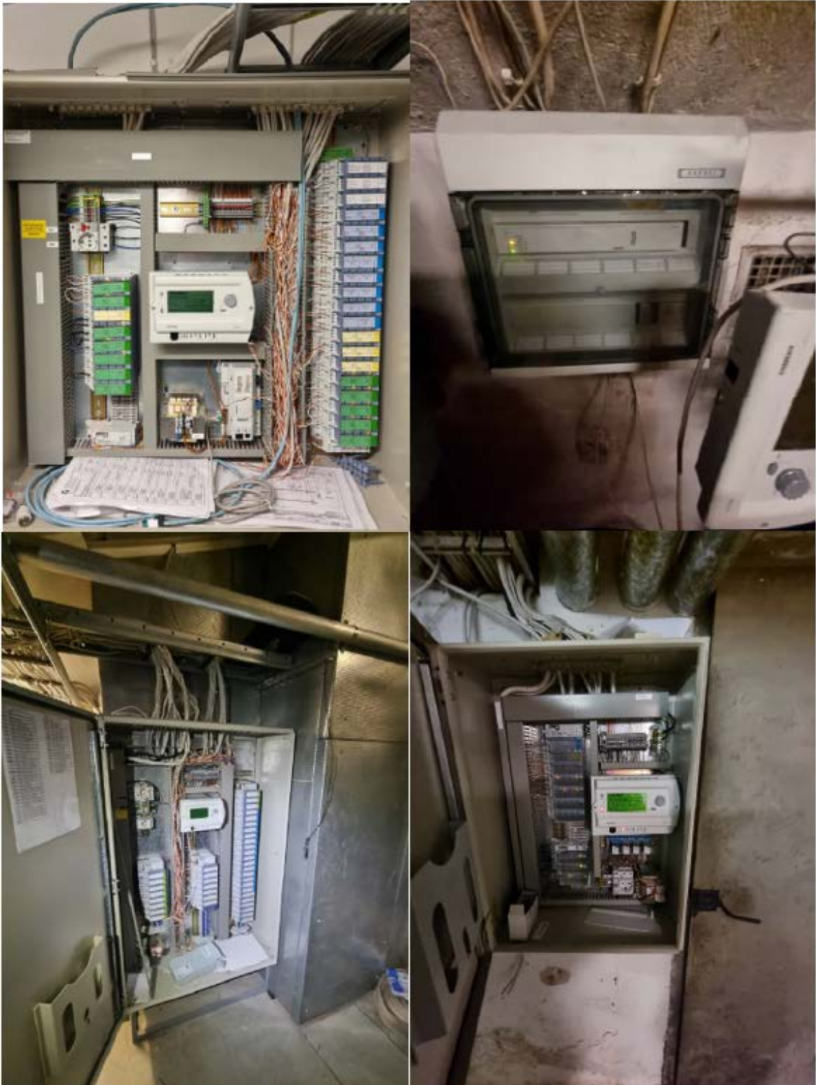
Kuva 3.19 Kuvissa vanhoja alakeskuksia. Vasemmalla ylhäällä vanha ohjauskeskus.
