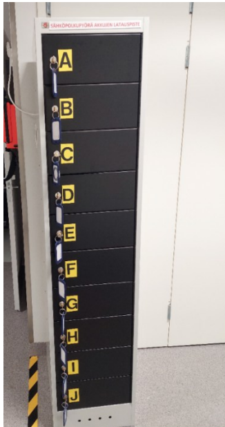
Kuva 6. Latauskaappi sähköpolkupyörien akuille
