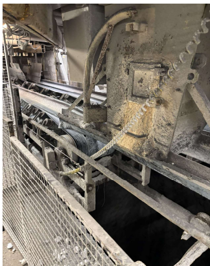
Kuva 10. Kivihihna 7 alla on pudotus kivisiiloon.
