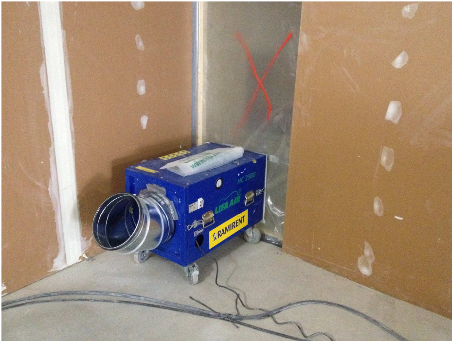
KUVA 10 P1-tilan ylipaineistaja ja suodatinyksikkö
