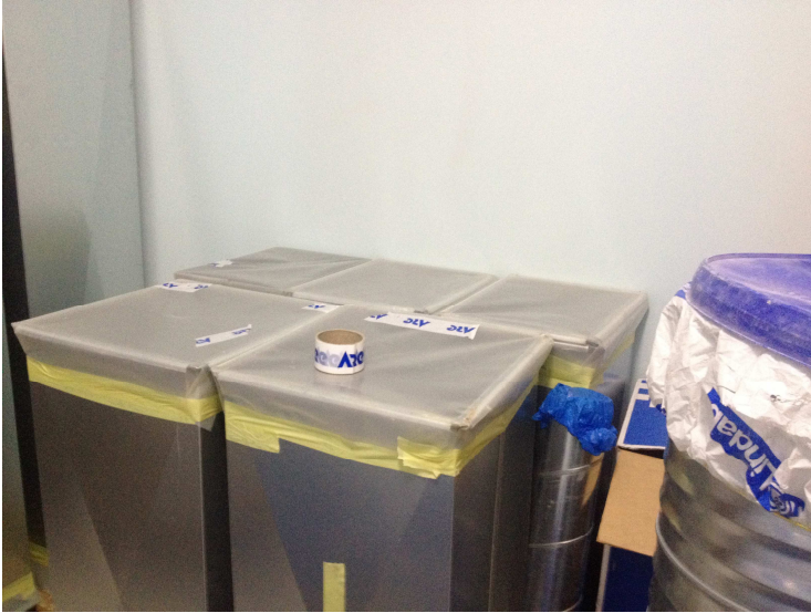
KUVA 6 Kantiset ilmanvaihtokanavat oikeaoppisesti suojattu lialta.
