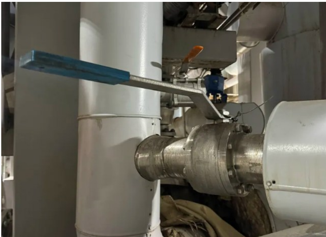
Kuva 4. Haihduttamon käsikäyttöinen palloventtiili ennen automatisointia.
