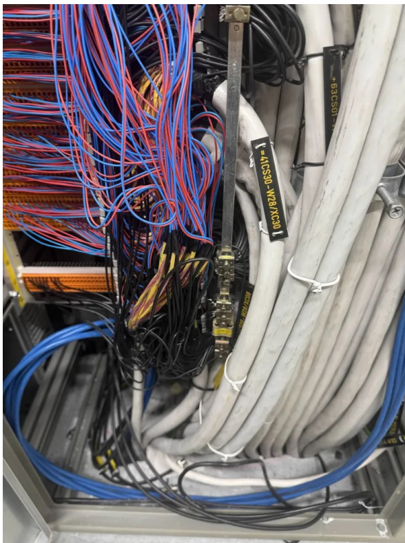
Kuva 7. Runkokaapeli +41CS30-W28/XC30 automaatiokaapissa.
