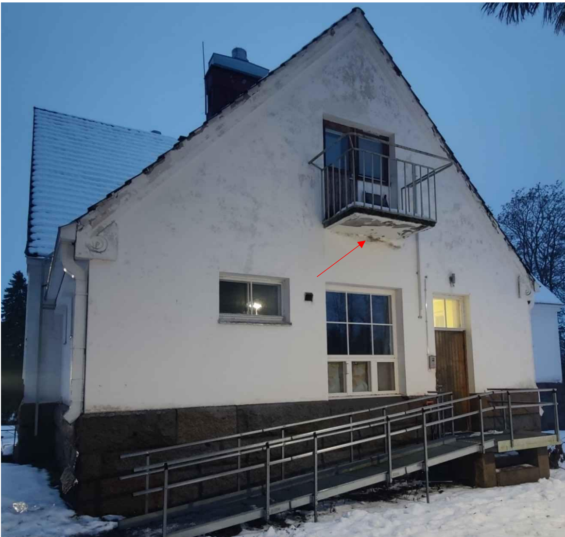
Kuva 2 Rapautunutta julkisivua takapihan päädyssä.
