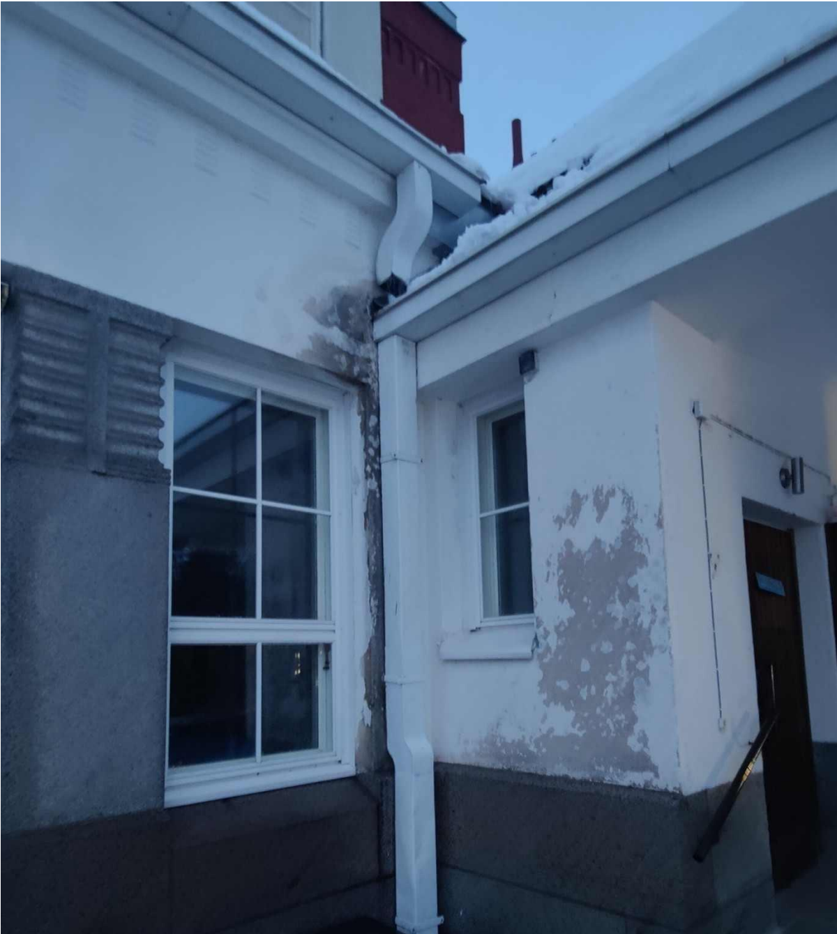
Kuva 4 Rapautunutta julkisivua sisäänkäynnillä.
