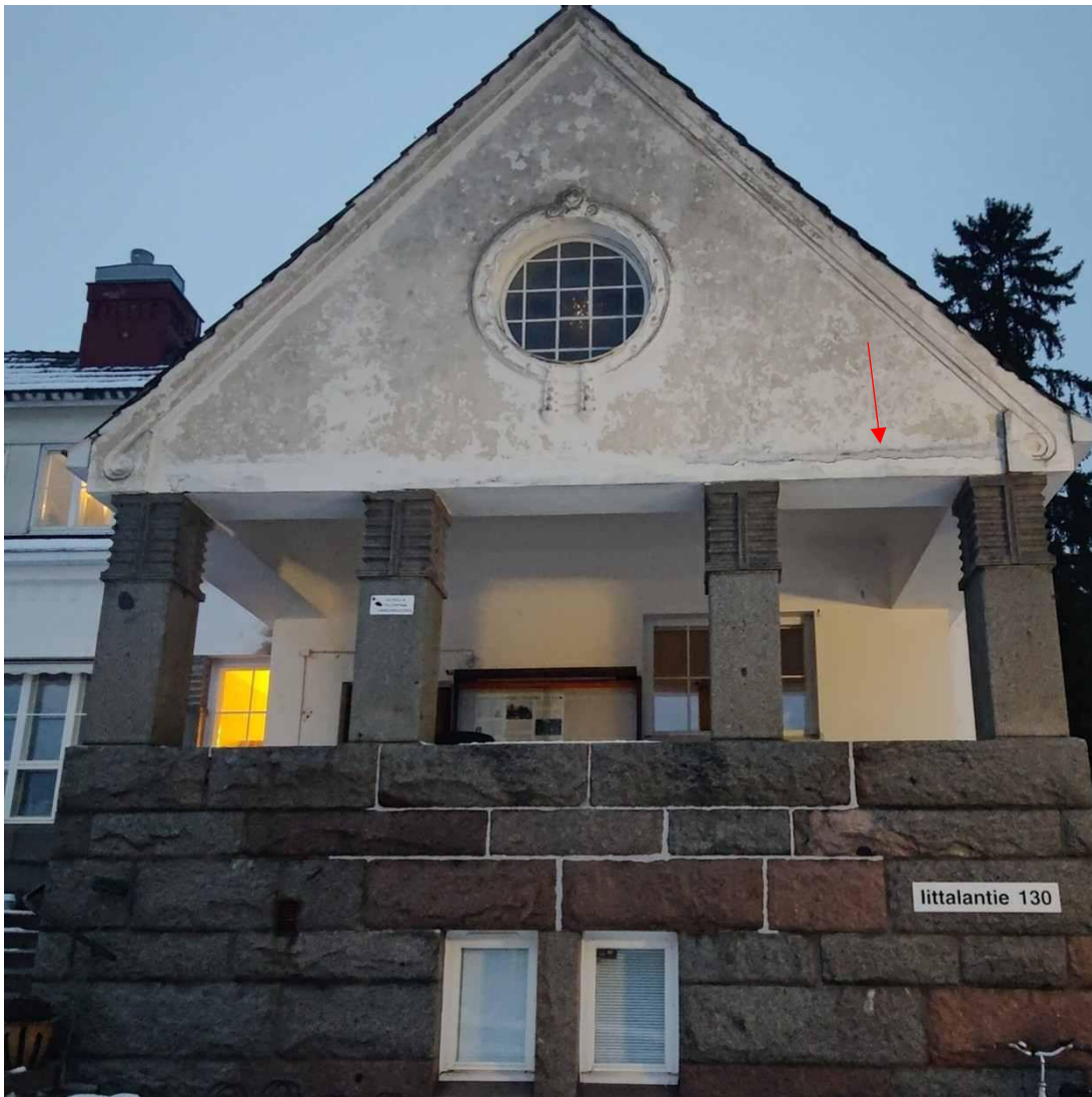
Kuva 3 Rapautunutta julkisivua etupihalla. Isokokoinen halkeama palkin alareunassa.
