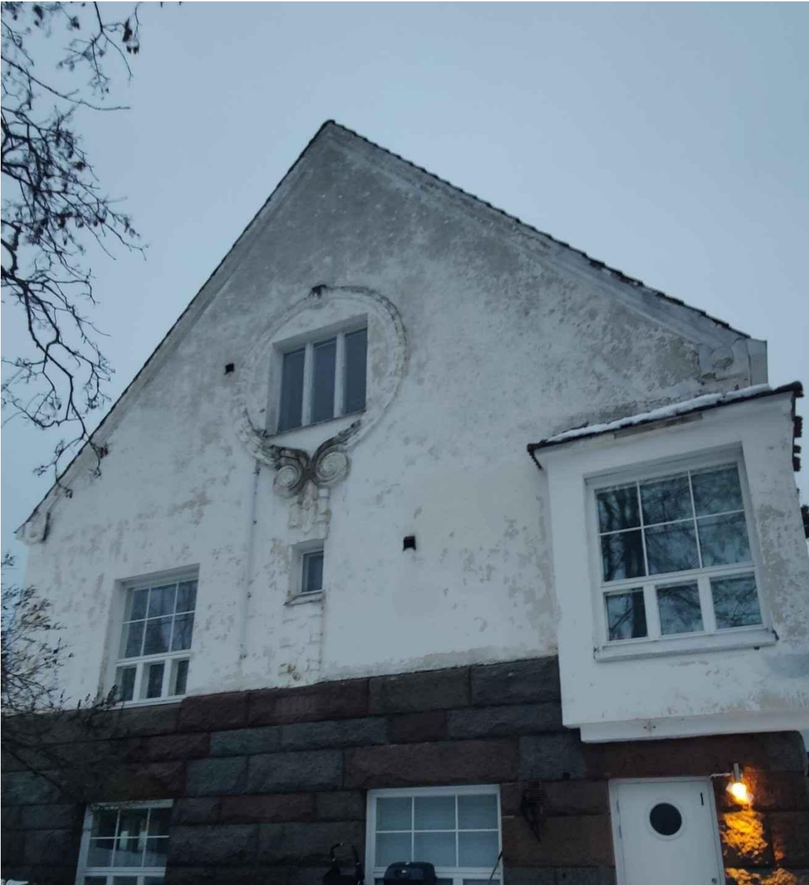
Kuva 5 Rapautunut rappaus länsipääty.
