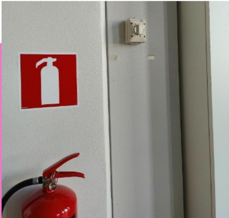
Kokoussalin takaseinällä palosammutin ja lisäilmastointilaitteen kytkin.
