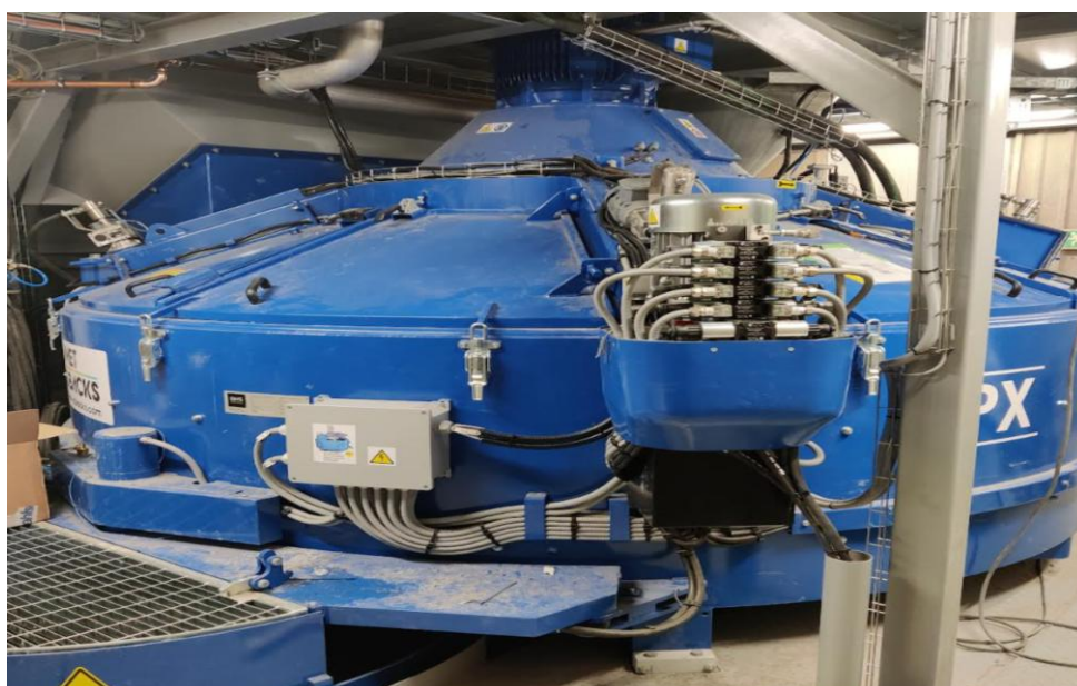
Kuva 12. Betoniaseman mylly. (Sahlsten 2026)
