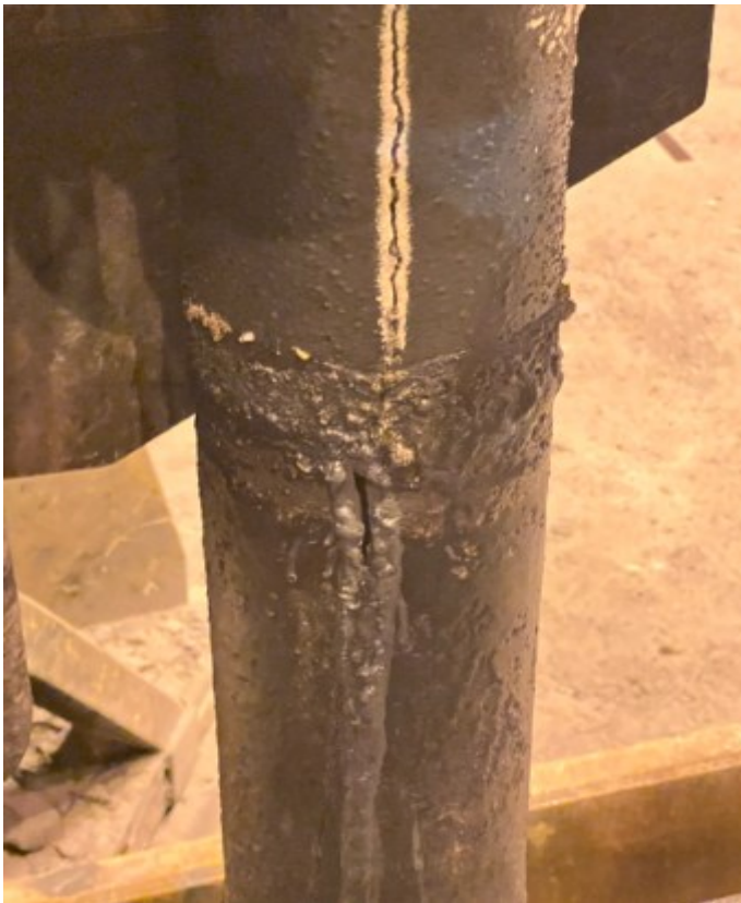
KUVA 10 Kuvassa halkeama suihkunsuojaputkessa
