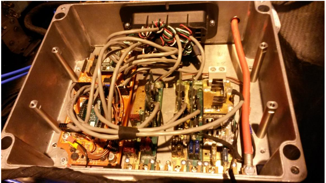
Kuva 14. Valmis ohjainlaitekotelo, jossa on kaksoissuojatut kaapelit
