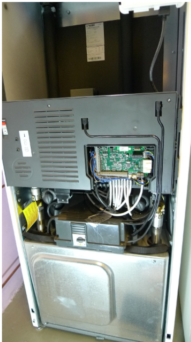
Kuva 2: Lämpöpumpun etukansi ja kytkentärasian kansi avattuna
