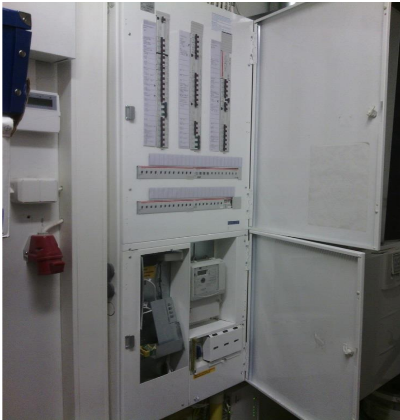
KUVA 13. Ensto ENSV345.48 it-mittauskeskus asennettuna (Lämsä 2015-02-27.)
