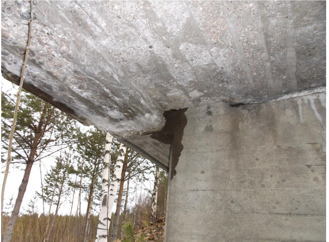
Kuva 5. Reunapalkin alapinnan rapautumaa ja vesivuoto. (Heikkinen Mikko)
