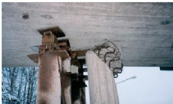
Kuva 7. Sillan välituen pilarin törmäysvaurio ja väliaikainen tuenta. (SILKO 1.201 2007, 5.)
