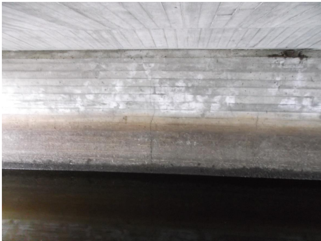
Kuva 3. Halkeamia Louhiojan sillan etumuurissa. (Heikkinen Mikko)
