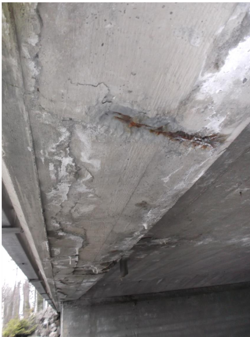
Kuva 4. Teräskorroosio on irrottanut betonipeitteen. (Heikkinen Mikko)
