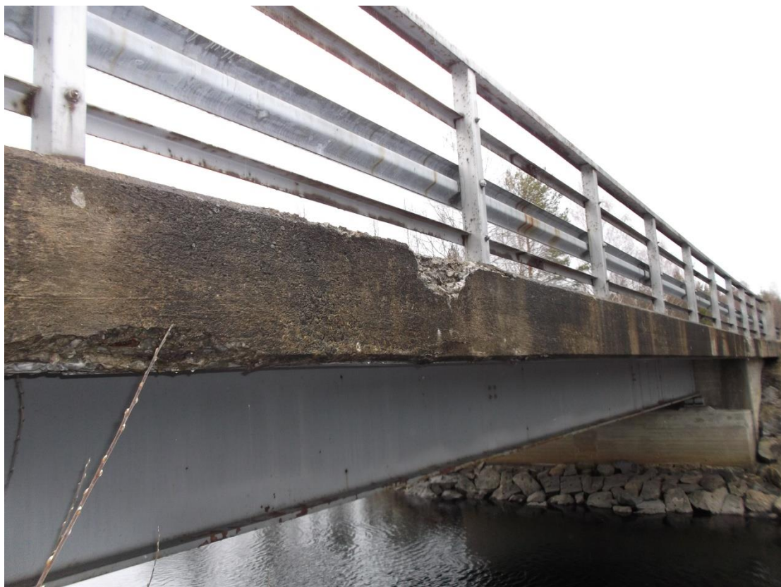
Kuva 6. Todennäköisesti veden jäätyminen aiheuttama vaurio reunapalkissa. (Heikkinen Mikko)
