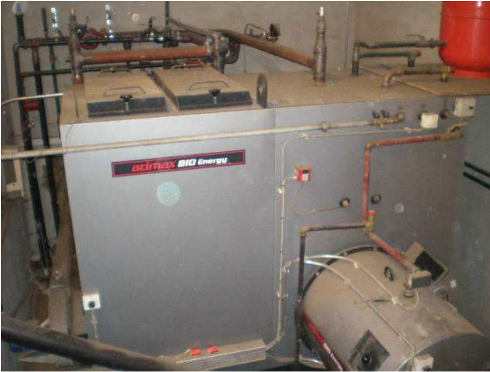
Kuva 3.2 Hakelämpökeskus, josta lämpö otetaan viljankuivaamolle.
