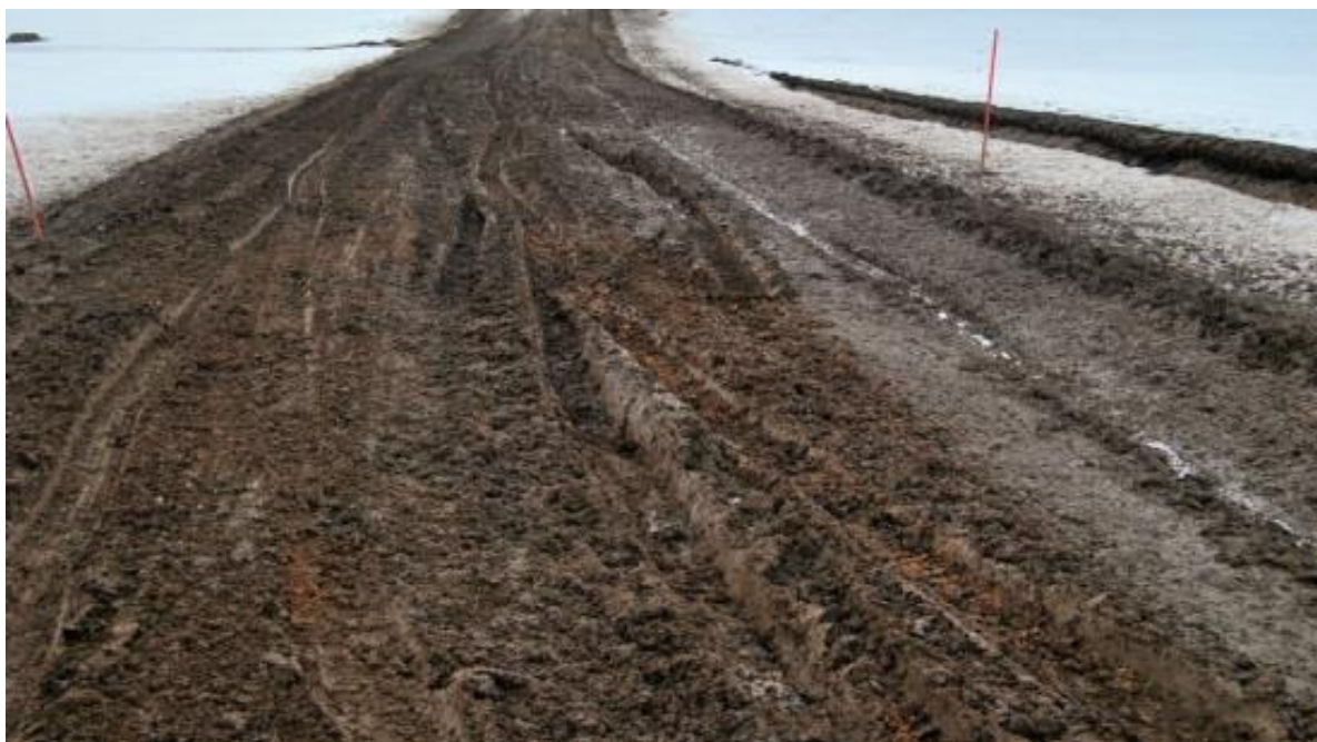
Kuva 4 Runkokelirikkoa lähempää kuvattuna. Tie oli mennyt paikoin niin huonoon kuntoon, ettei siitä meinannut päästä autolla yli. (Kuva Henna Vauhkonen 2015).
