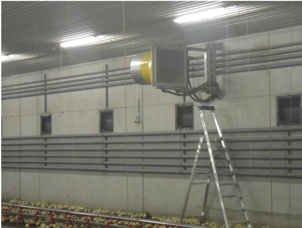
Kuva 2. Broilerihallin lämmityspotket ja ilmapuhallin.
