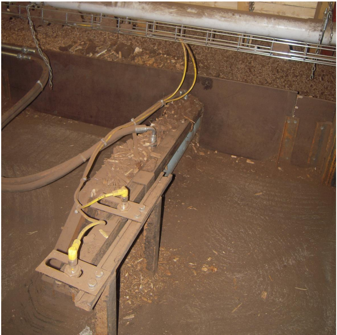
Kuva 5. Tankopurkaimen runkopukki ja hydraulisynteri.
