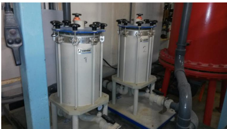
Kuva 16 Ionivaihdetun veden patruunasuodatin
