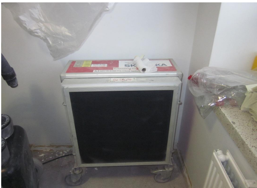
Kuva 3. Ilmanpuhdistin. Kuva Kylliäinen, Juho.
