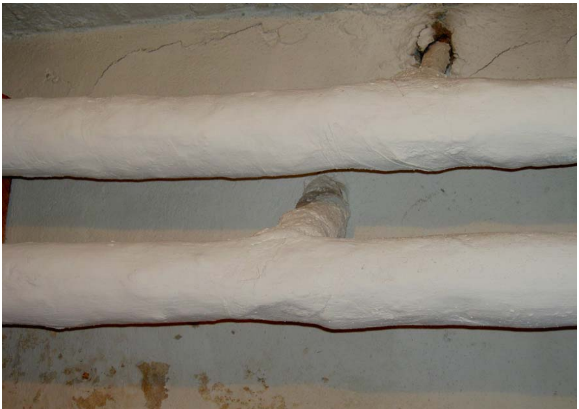
Kuva 14. Kellarin seinän hilseilyä ja putki eristeet sisältävät todennäköisin asbestia
