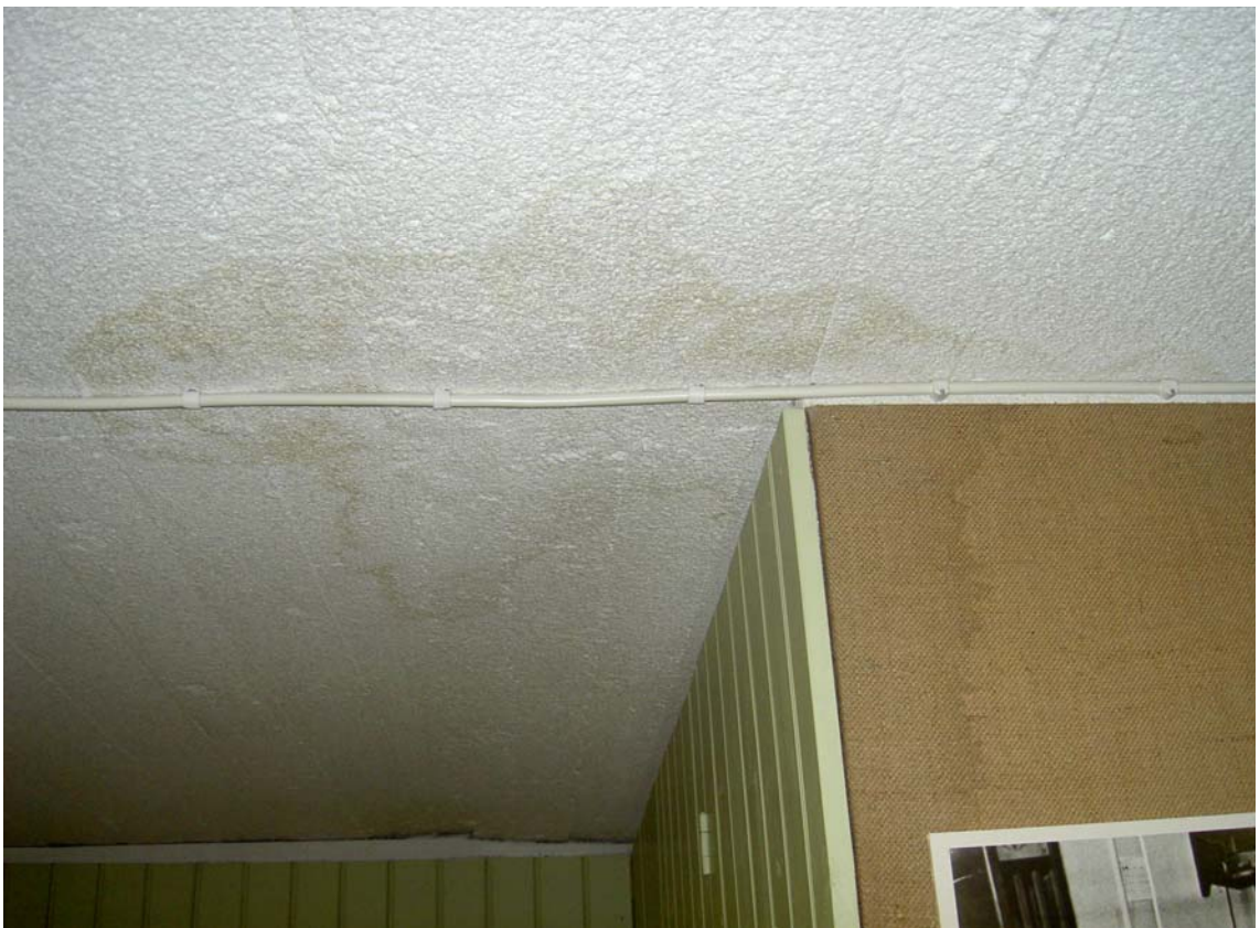
Kuva 16. Kosteuden aiheuttamia jälkiä kellaritiloissa
