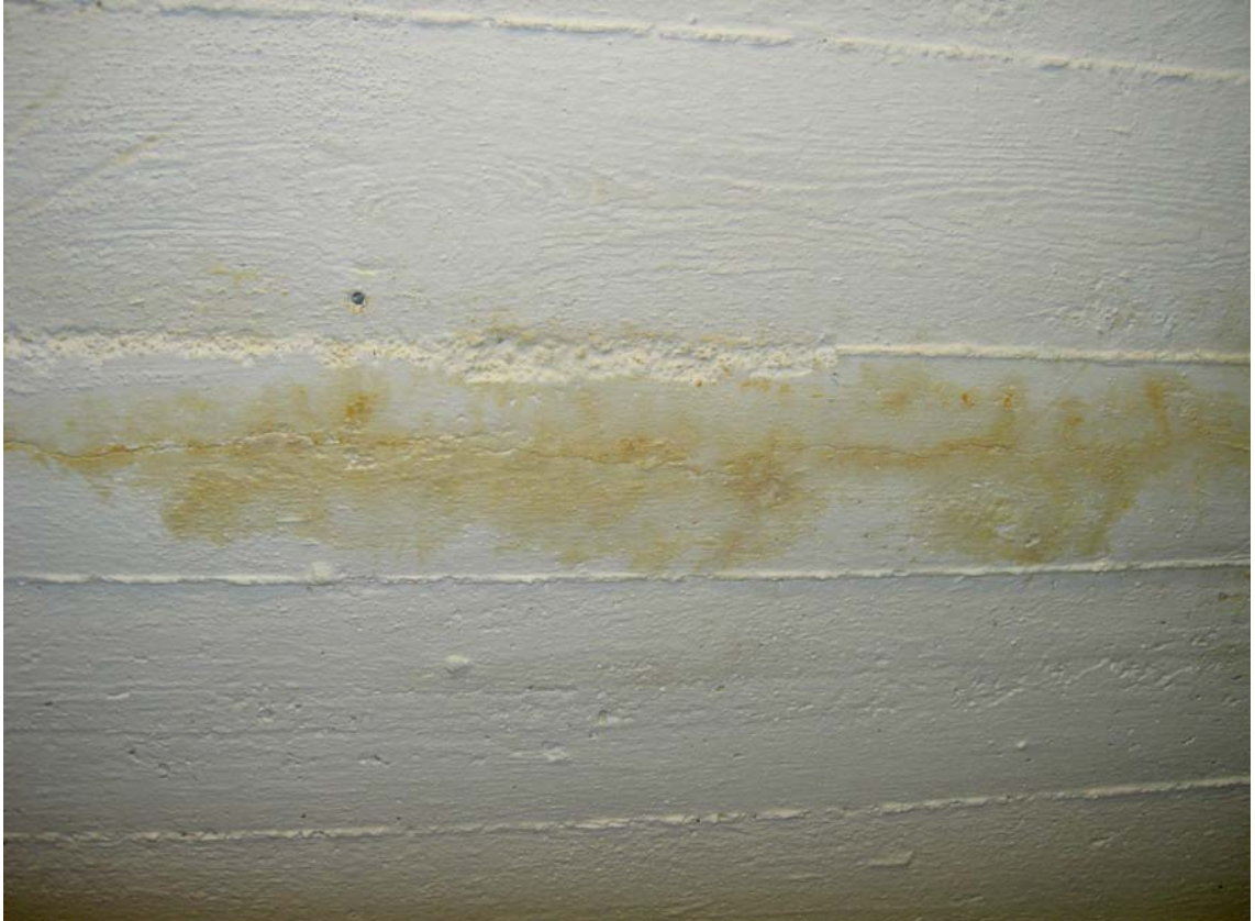
Kuva 17. Kosteuden aiheuttamia jälkiä kellarin katossa
