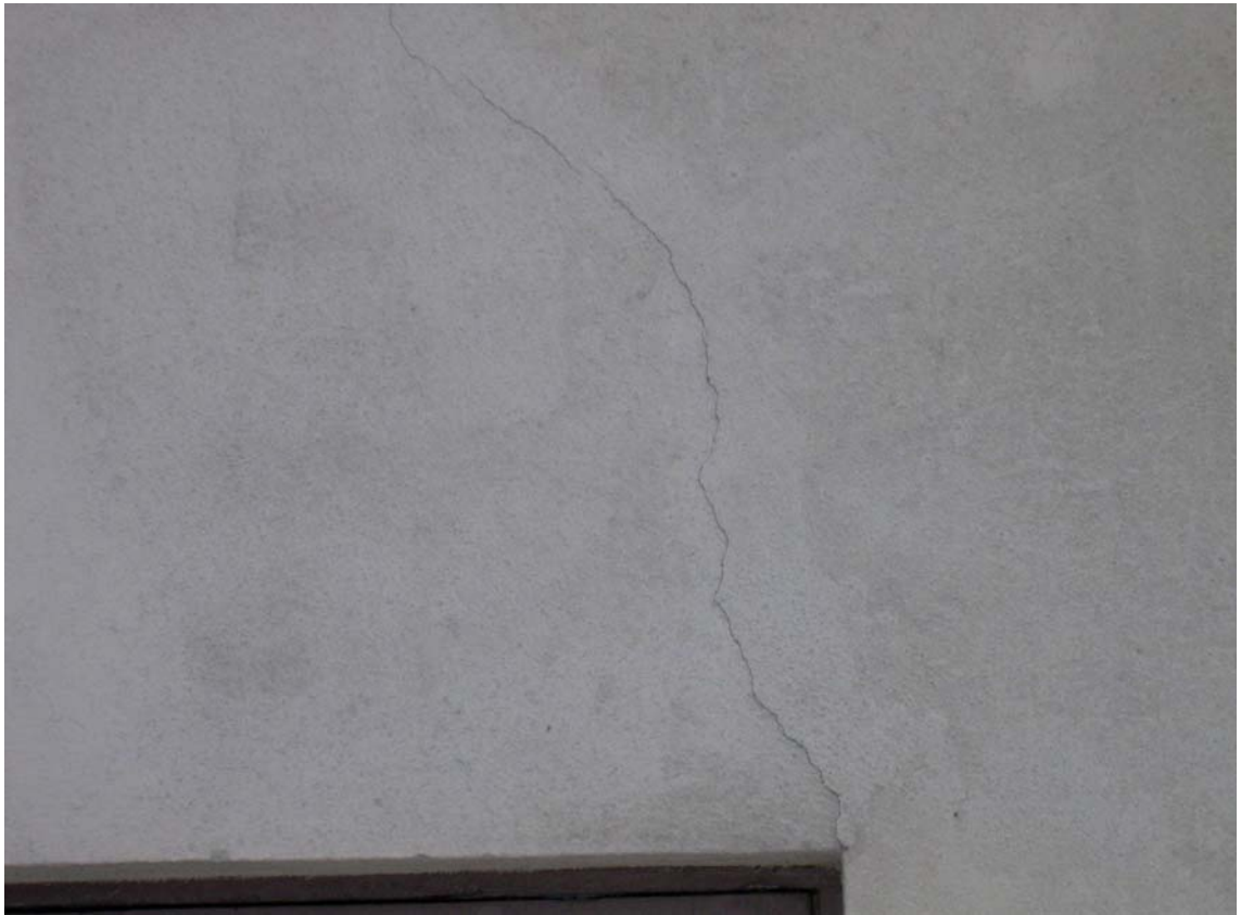
Kuva 5. Päärakennuksen seinissä ilmenneitä halkeamia
