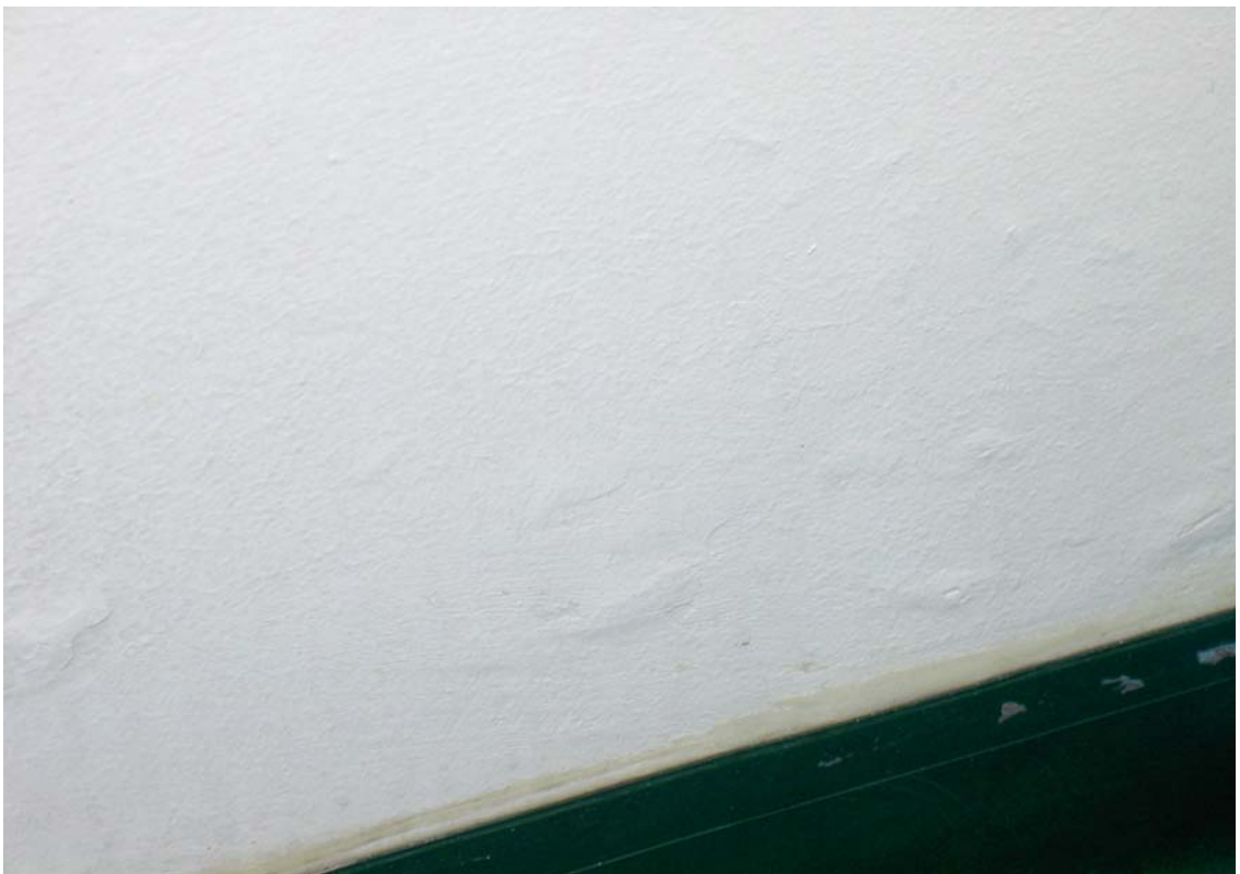
Kuva 20. 2. Kerroksen pukuhuoneen vesipisteen viereisessä seinässä pullistumia
