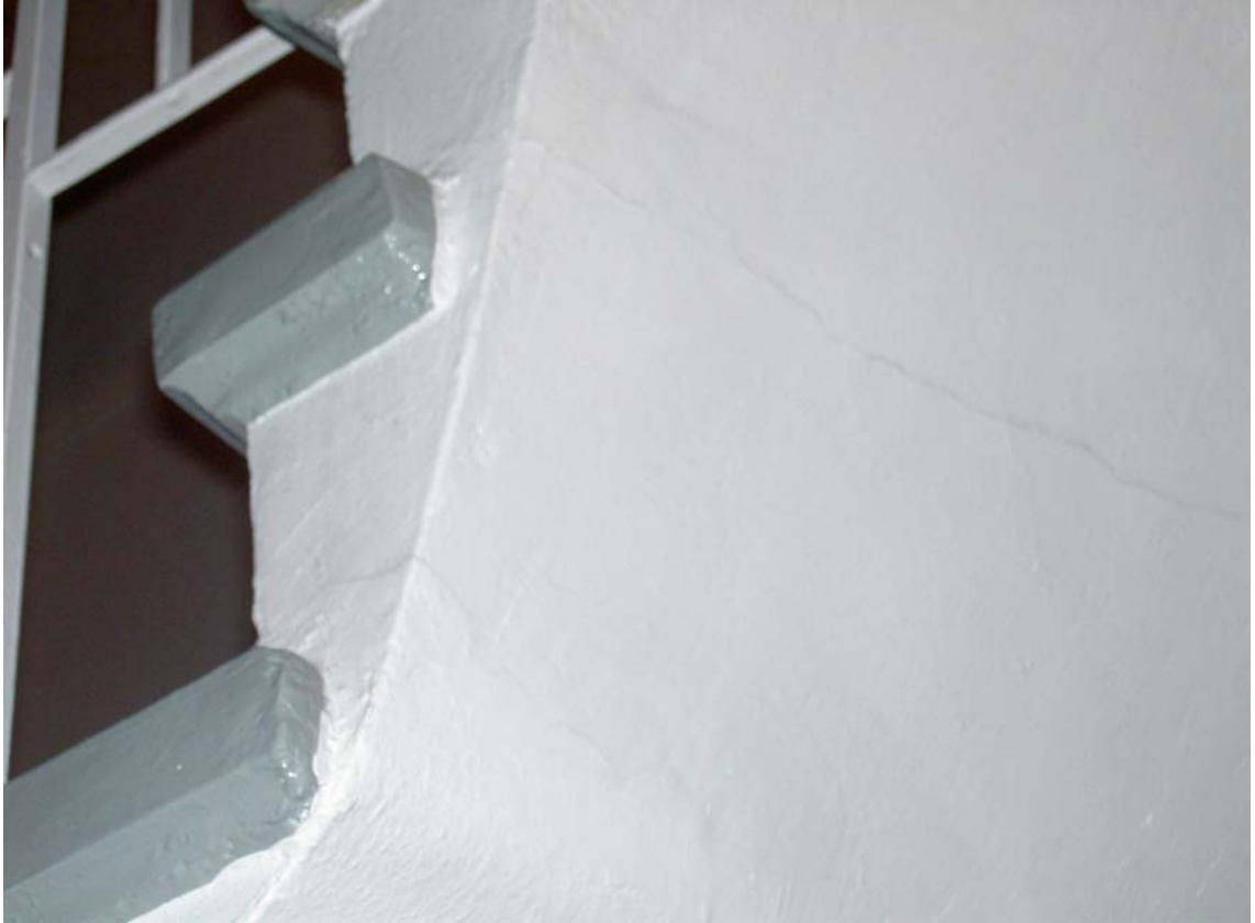
Kuva 19. Portaikoissa ilmenneitä koko leveyden mittaisia halkeamia
