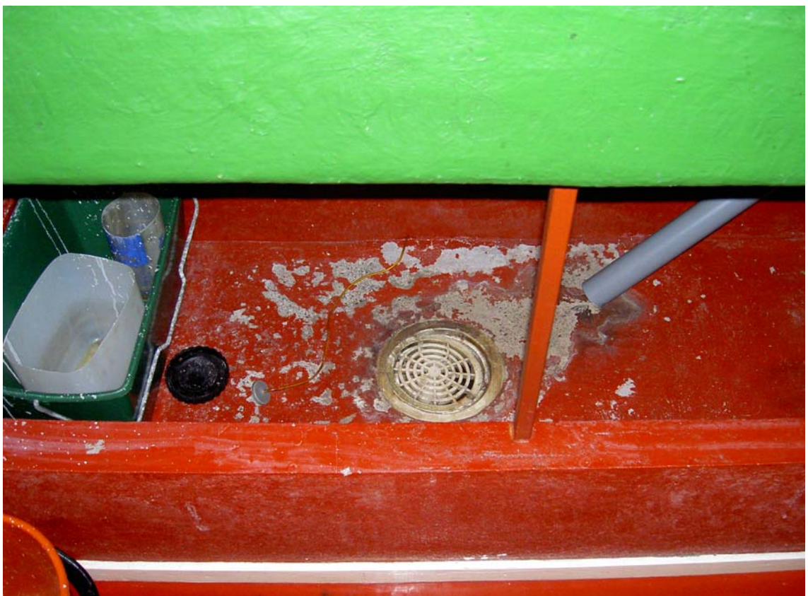
Kuva 24. Valokuvien kehitysvesien laskuamme on vaurioitunut
