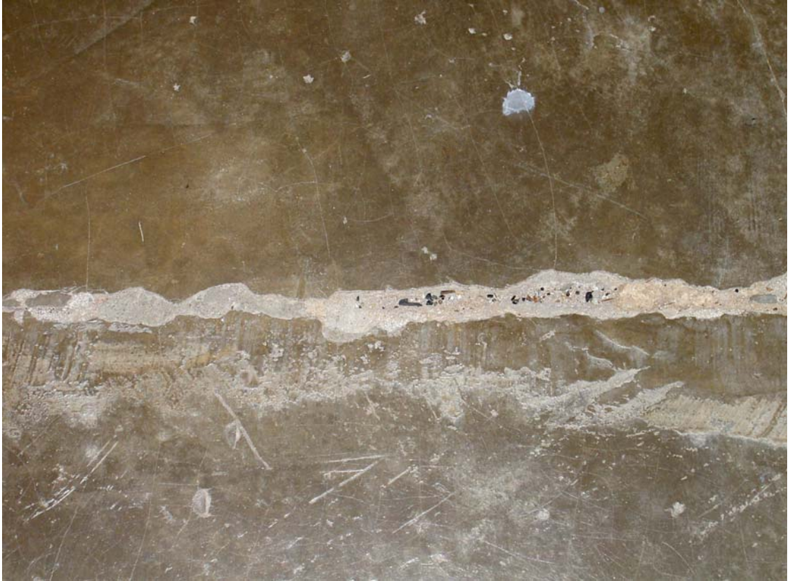
Kuva 9. Alapohjassa ilmenneitä halkeamia
