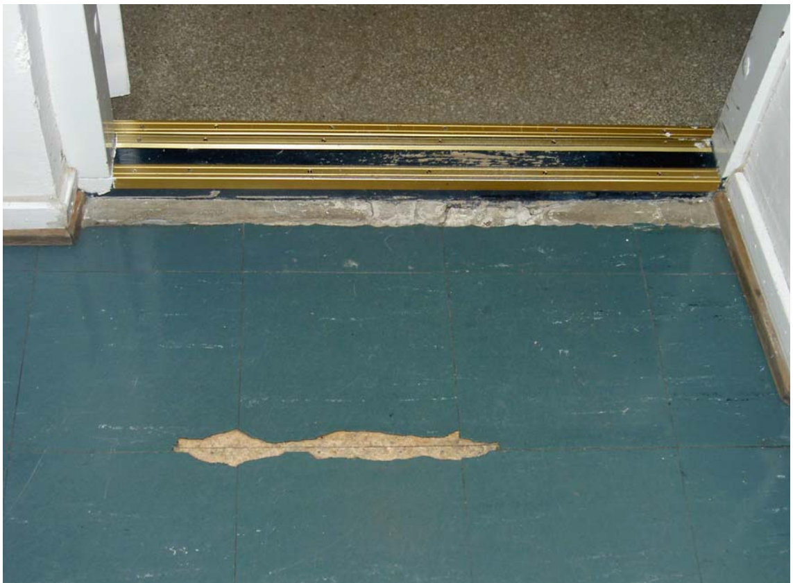
Kuva 22. Vikoja 2. Kerroksen lattiassa
