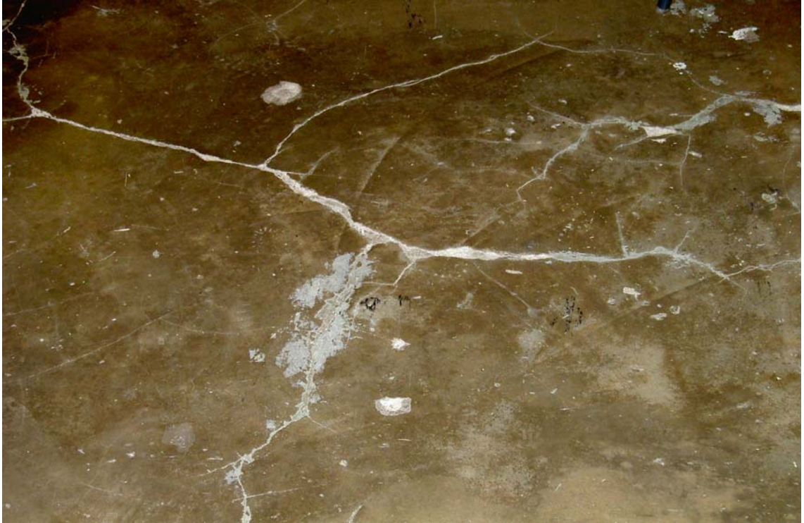
Kuva 1. Kellarin lattian halkeamia
