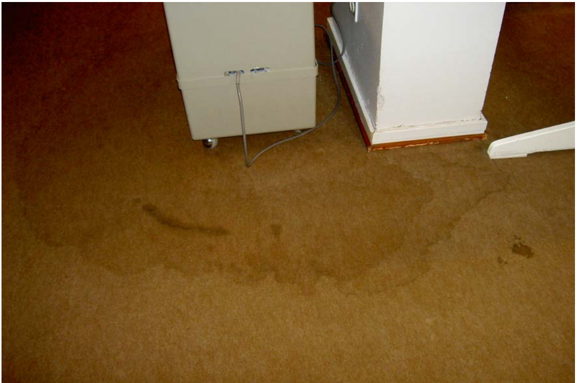
Kuva 2. Kosteuden aiheuttamia tummentumia näyttelytiloissa
