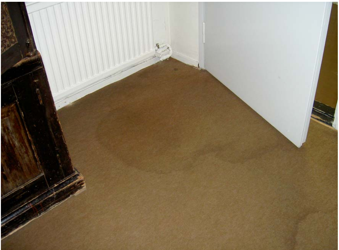
Kuva 18. Kosteuden aiheuttamia jälkiä 1. kerroksessa
