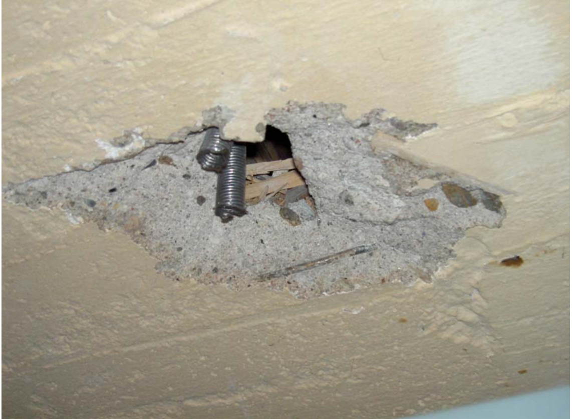
Kuva 15. Niin vanhat, kuin uudetkin läpiviennit ovat paikkaamatta
