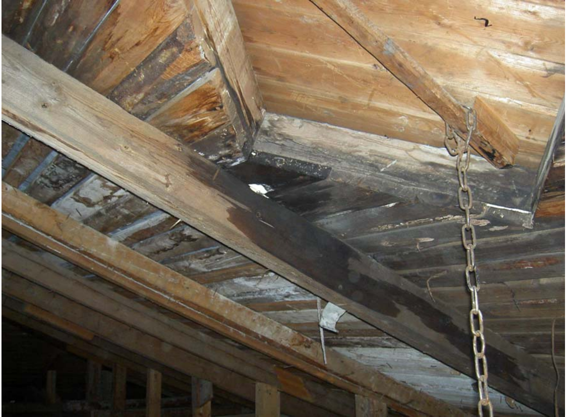
Kuva 25. Vuotokohtia kattoluukun ympärillä ullakolla
