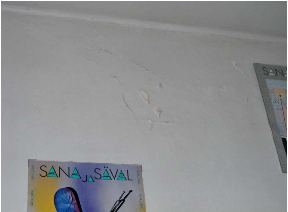
Kuva 23. Porrashuoneen (1.2.56) seinässä havaittuja vikoja
