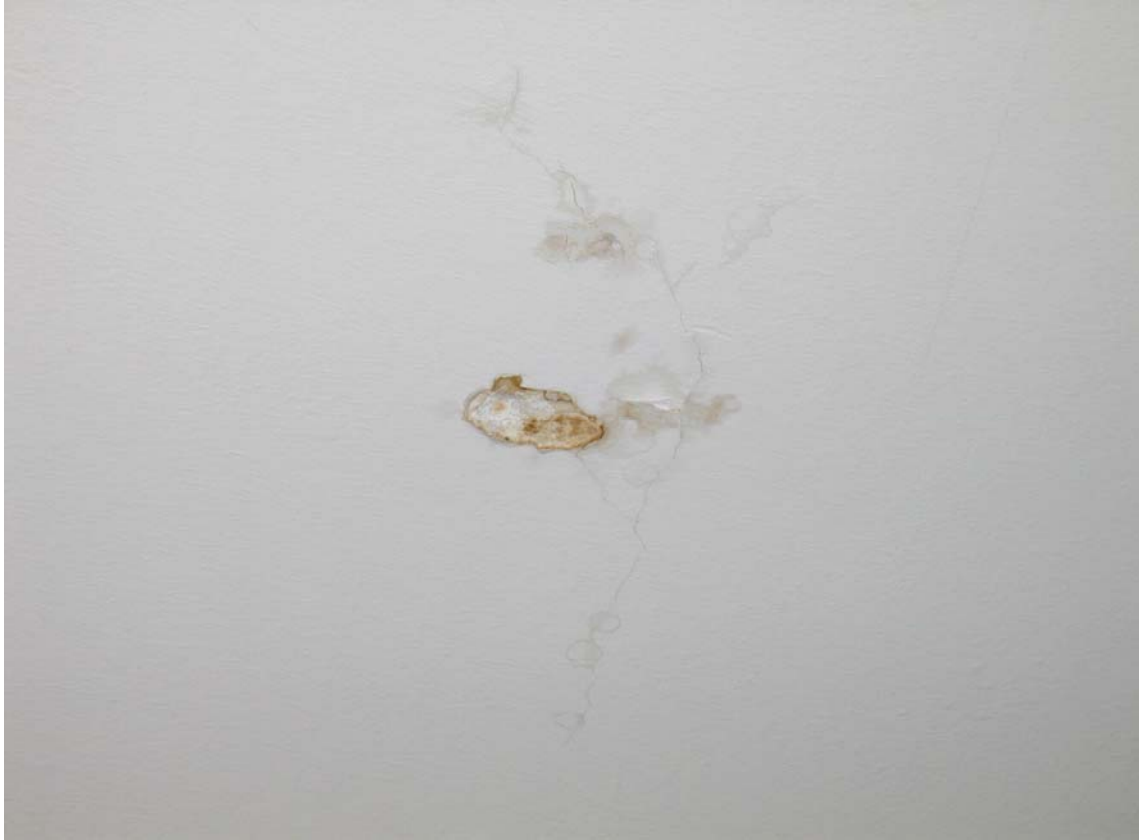
Kuva 21. Huone numero 1.2.48:n katossa havaittuja kosteuden jälkiä
