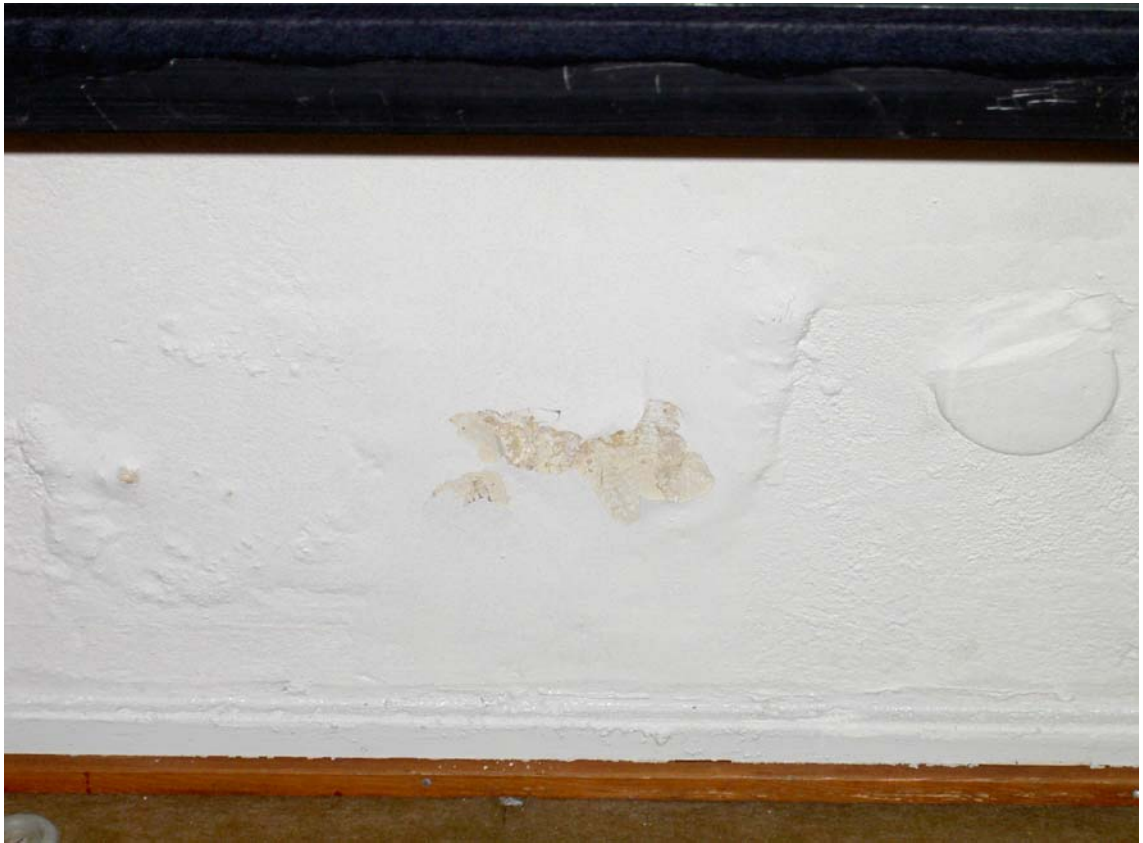
Kuva 13. 1. Kerroksen seinässä ilmennyt kosteusvaurio
