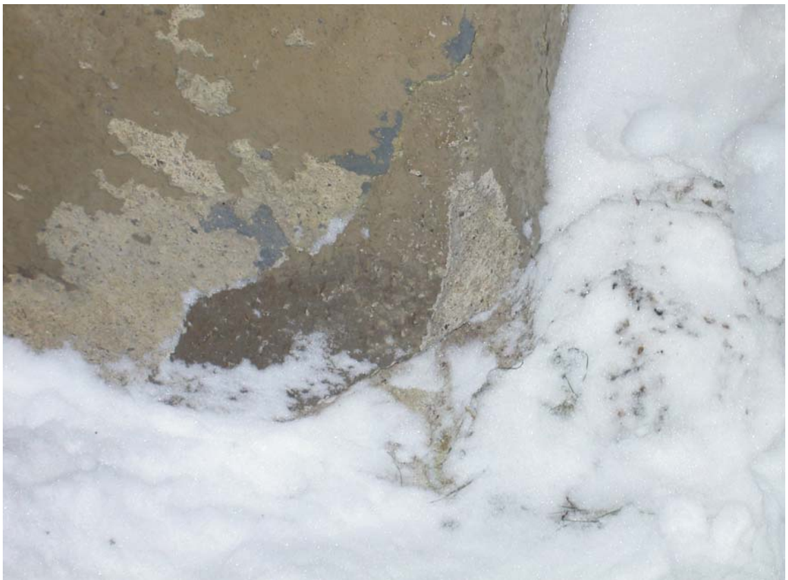
Kuva 4. Päärakennuksen nurkan vaurio
