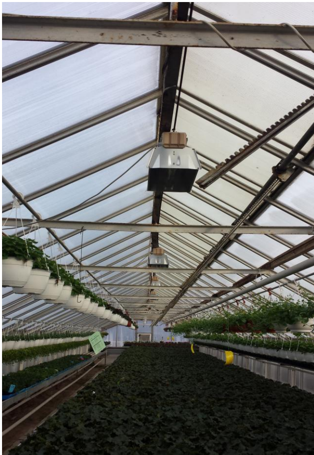
Kuva 18. Kasvihuoneessa olevia 400 W:n valaisimia.
