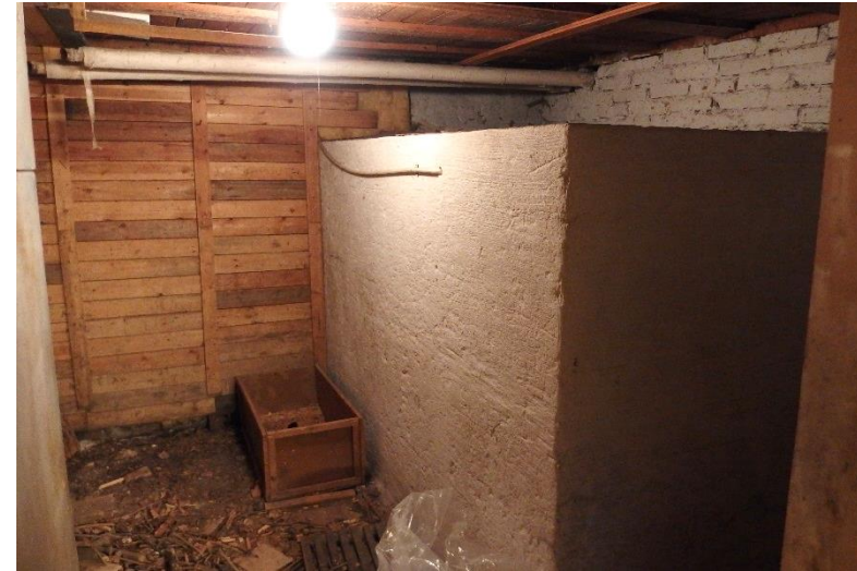
Kuva 20. Rintamamiestalon kellarissa sijaitsee käytöstä poistettu öljysäiliö.
