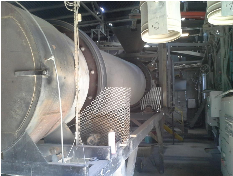
KUVA 3. Tulipesä ja kuivausrumpu laitteineen (5)
