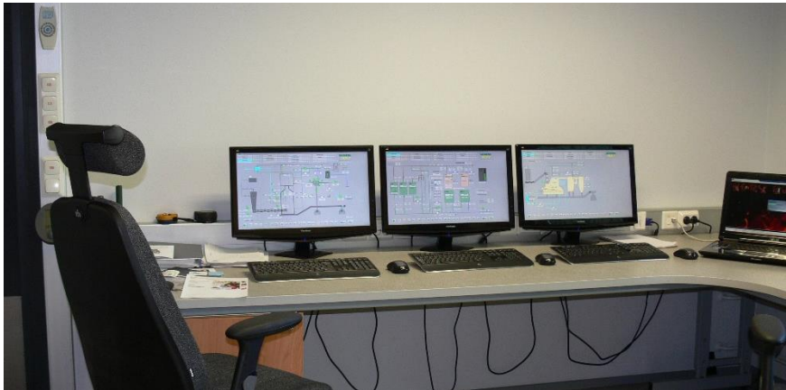
Kuvio 8. Ahjolan kaukolämpölaitoksen valvomo
