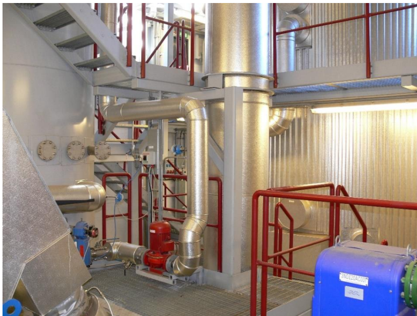
Kuvio 7. Ahjolan kaukolämpölaitoksen tekniikkaa
