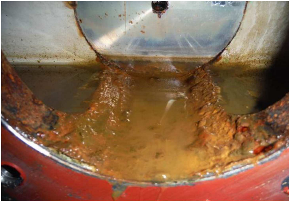
Kuva 4 Korroosio- ja bakteerikasvustoa
