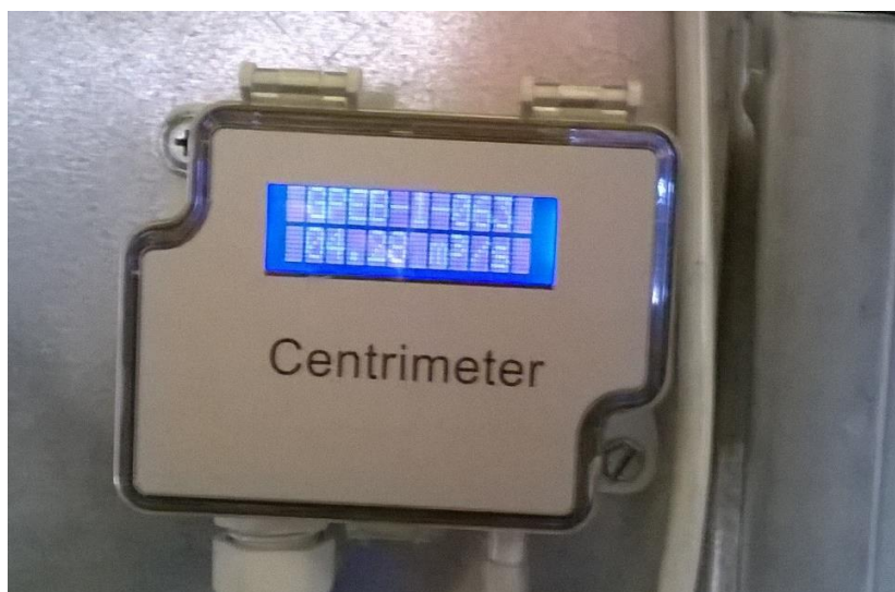
KUVA 6. Ilmavirtamittaus paine-eron avulla (tuloilma)
