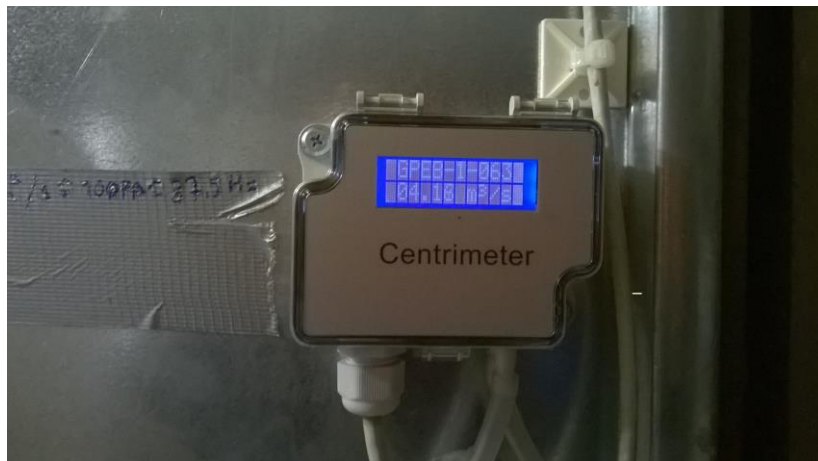
KUVA 5. Ilmavirta mittaus paine-eron avulla (poistoilma)
