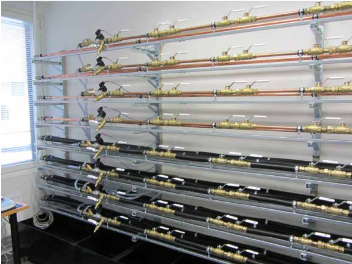
Kuva 2–4. Pilottiverkoston neljä kuparilinjaa ja neljä PEX-linjaa. Kussakin linjassa on viisi perättäistä putkikeräintä. Lisäksi PEX-putket on peitetty UV-valolta mustalla suojaputkella.
