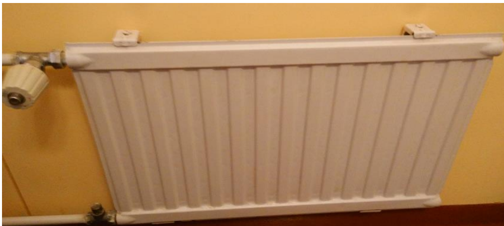
KUVA 16. Lämmityspatteri ja termostaatti (Kärkkäinen 2015-04-08.)
