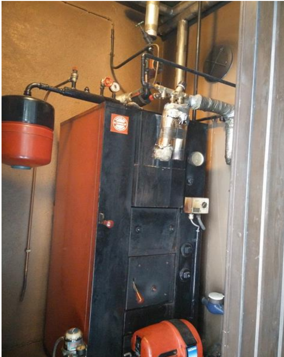
KUVA 11. Öljylämmitysjärjestelmä pannuhuoneessa (Kärkkäinen 2015-04-08.)
