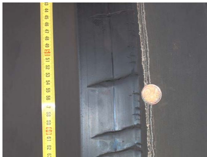
Kuva 9. Pinnoitteen kulunut pääty. Kuvassa kolikko on madalletun olakkeen puolella.
