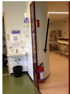
1 sammutin päiväsalin ulkopuolella
