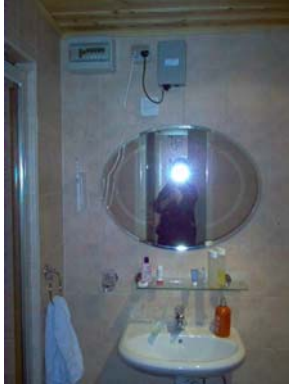
Kuva 32. Aputilojen kylpyhuoneen pesuallas (huom! sähköasennukset)
