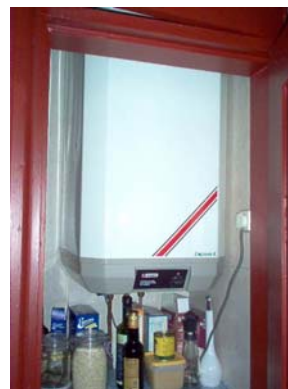
Kuva 14. Lämminvesivaraaja keittiön komerossa
