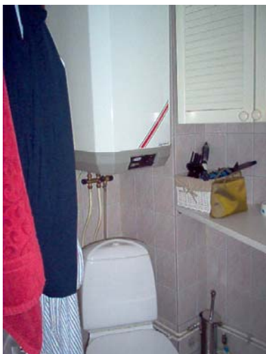
Kuva 47. Wc-istuin ja lämminvesivaraaja
