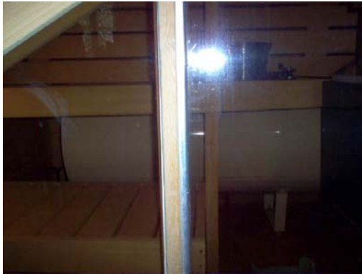
Kuva 53. Aputilojen saunan lauteiden alle sijoitettu lämminvesivaraaja
