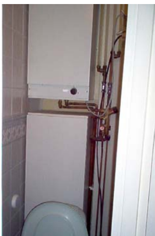
Kuva 29. Wc:ssä 2 kpl lämminvesivaraaja
