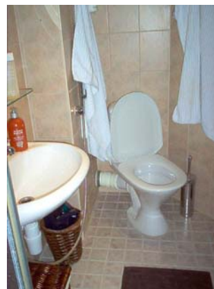
Kuva 34. Wc-istuin ja viemäröinti
