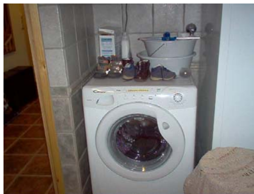
Kuva 42. Pesuhuoneeseen asennettu pesukone
