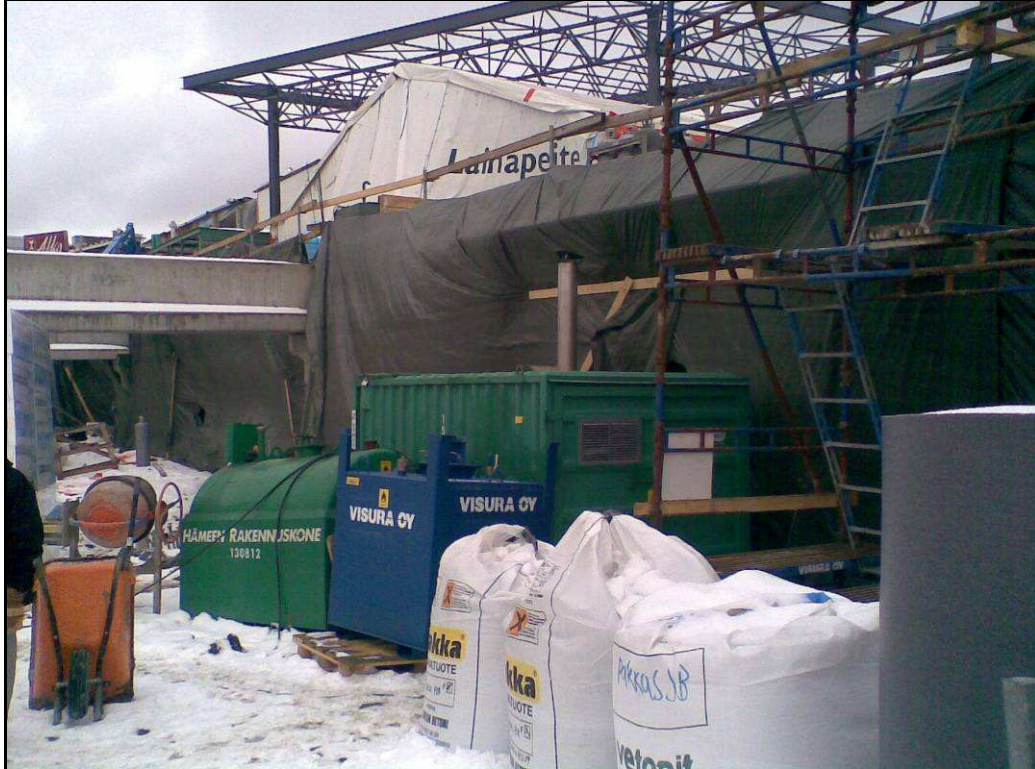
Kuvio 13: Lämpökontti, jonka tuottama lämpö on suunnattu pressujen taakse pysäköintihalliin
