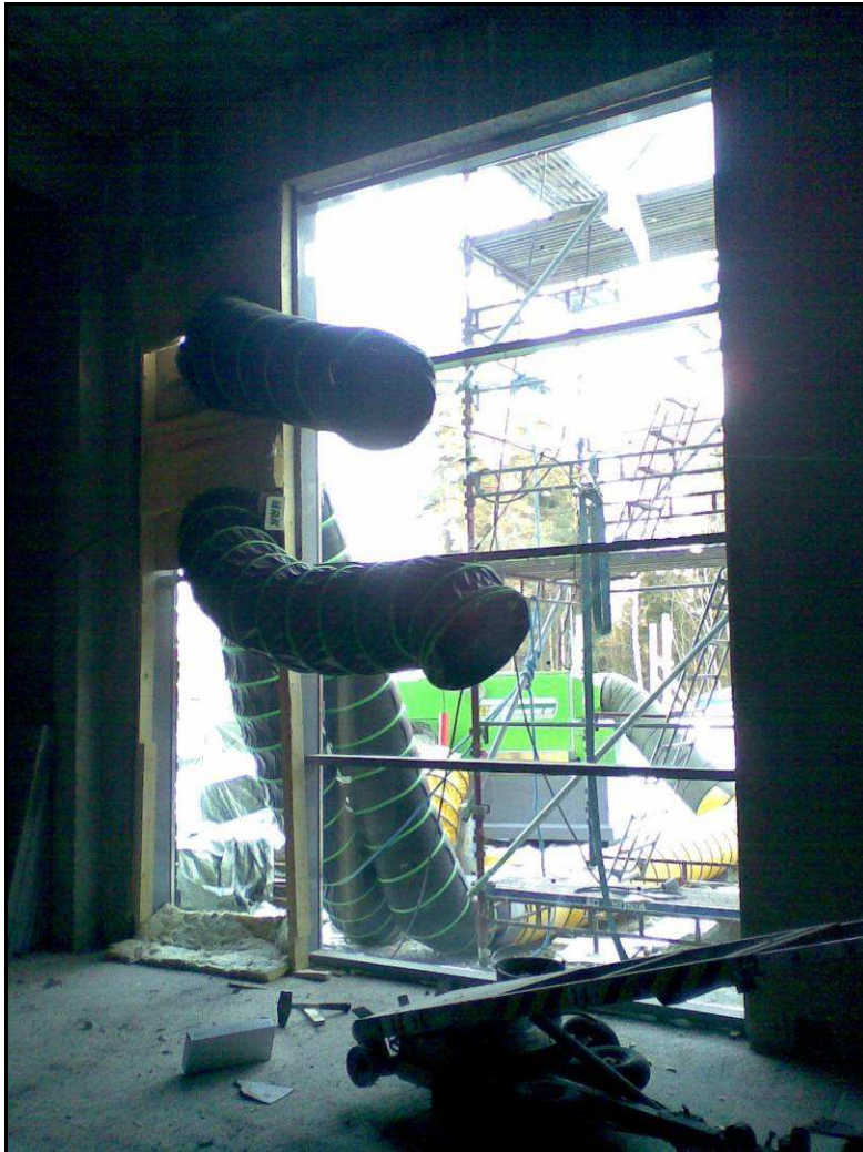
Kuvio 15: Lämpökeskuksen tulo- ja poistoilmaputket koulun liikuntasalissa
