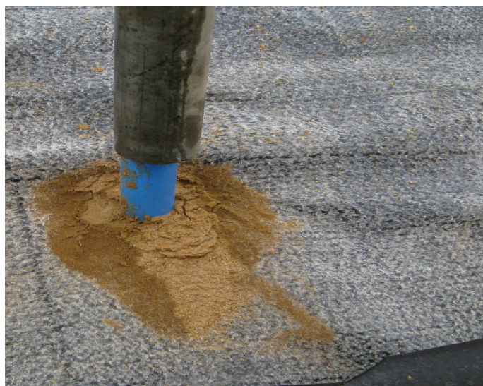
Kuva 10 Pohjaveden tarkkailuputken läpivienti
