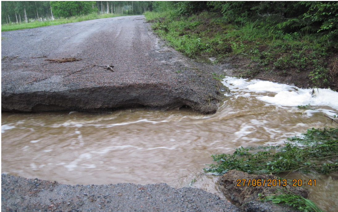
Kuva 16. Lavia 27.6.2013. Rankkasade on katkaissut tien ja vienyt maantierummun mennessään. Rumpu oli kulkeutunut noin 15m päähän maantiestä. (kuva: aluevastaava P. Hautaviita 2013)
