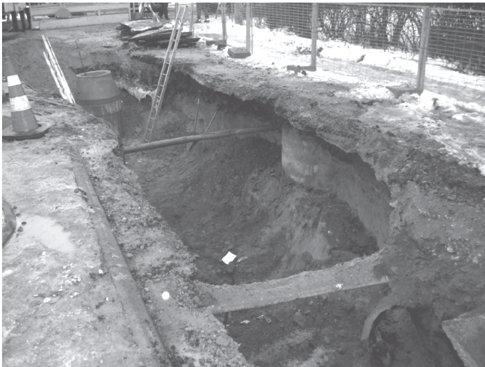
Kuvio 1: Kaivannon pystysuora seinä sortui maanrakennustyöntekijän päälle (Kuva 1, TOT 23/04)
